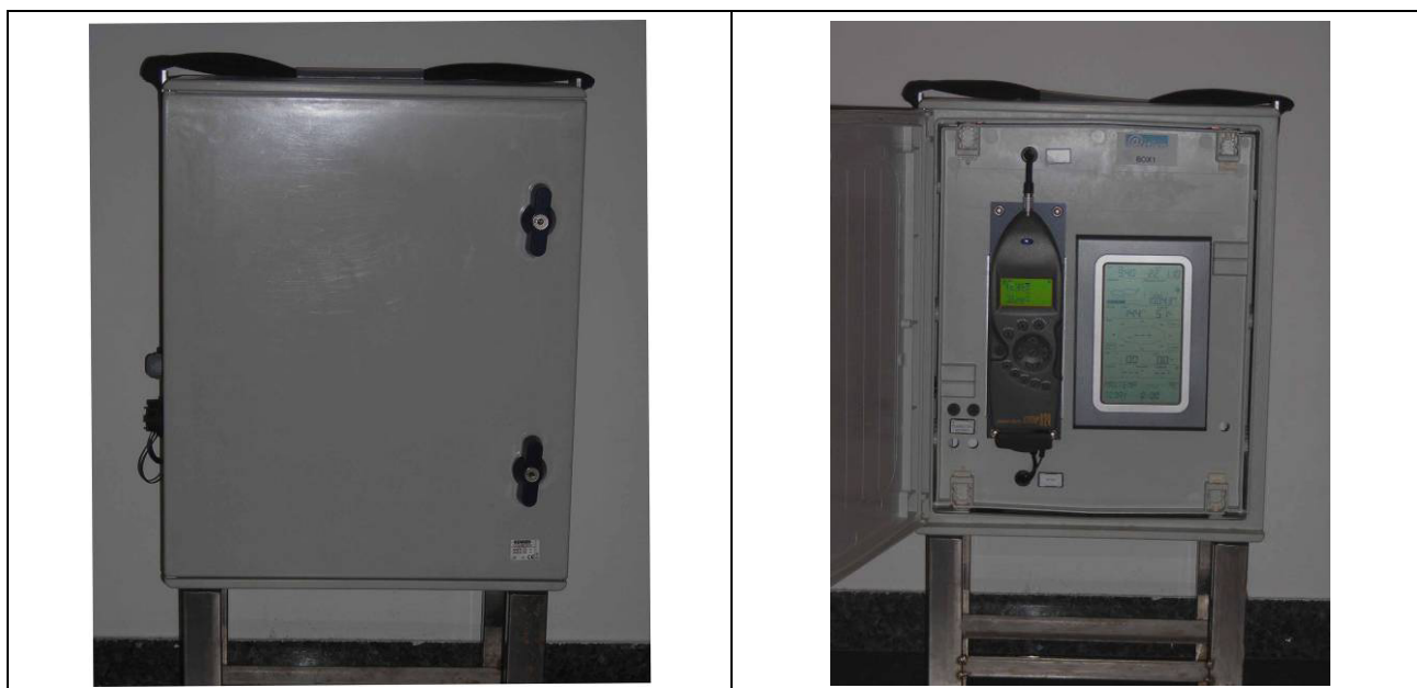
Fonometro e centralina meteo in box stagno
