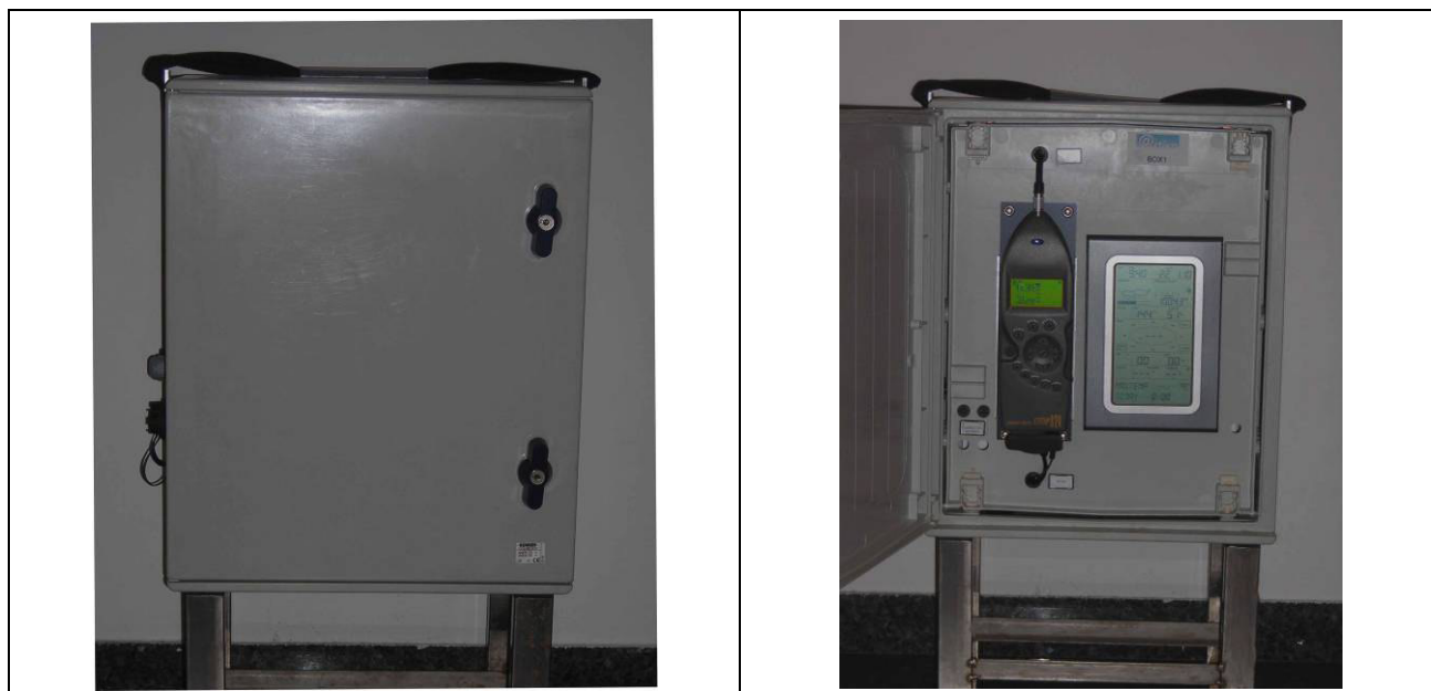
Fonometro e centralina meteo in box stagno
