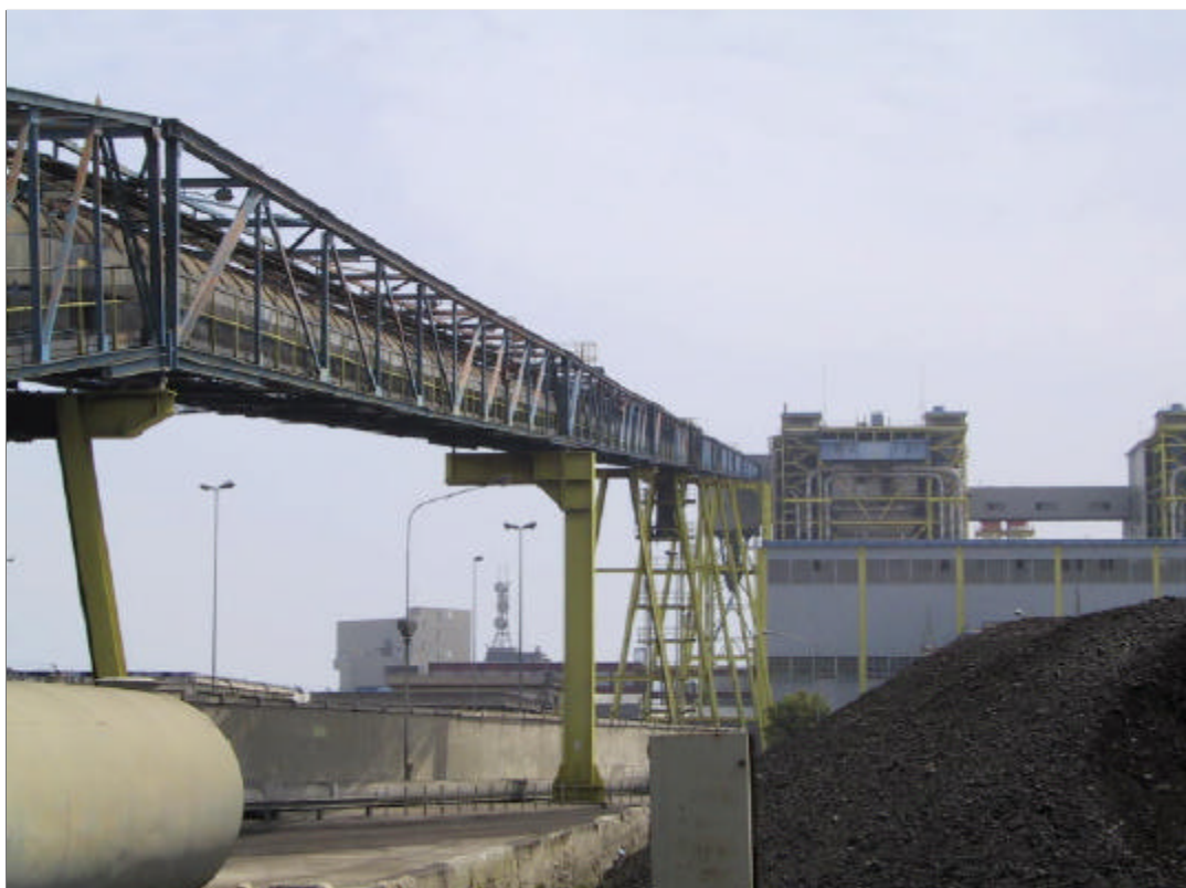
FOTO 3: Nastro carbone N6. Sullo sfondo, l'edificio caldaia del gruppo 1
