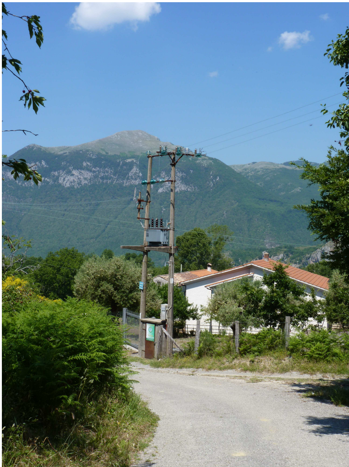
Figura 4.2.1-4 Linea MT da demolire (Comune di Laino Castello - linea aerea MT Laino der. Fiumicello)
