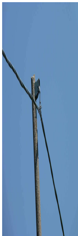
Figura 4.2.1-2 Tratti di linee BT già realizzati in cavo precordato (Comune di Laino Borgo – Cab.S. Filpo)
