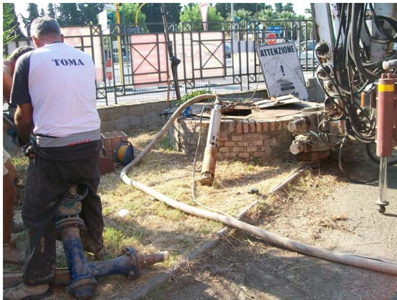
Fig.2) Particolare Pompa Caprari serie E4XP con motore LOWARA serie 4OS – Pozzo5
