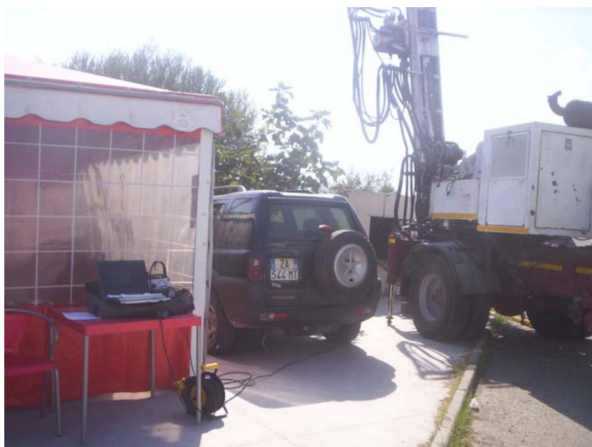
Fig.3) Misurazioni e stazione PC – Pozzo6
