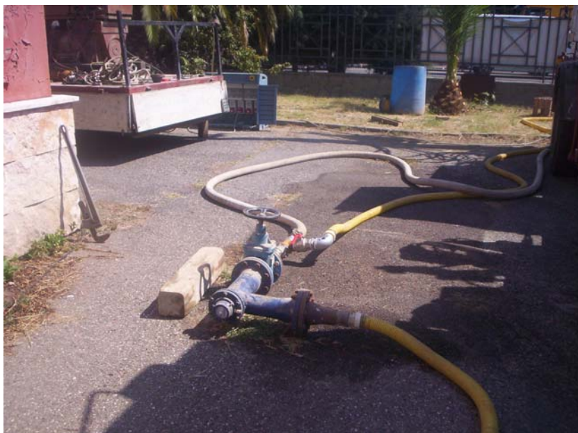
Fig.5) Particolare Contalitri tarato – Pozzo5
