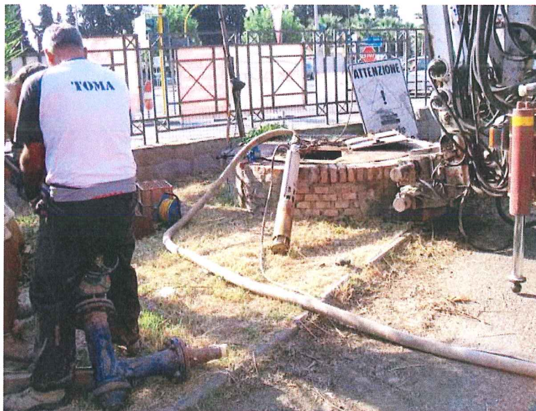
Fig.2) Particolare Pompa Caprari serie E4XP con motore LOWARA serie 4OS – Pozzo5
