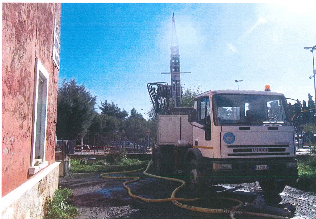
TEST IDRAULICO POZZO P5 (tubazione e misuratore di portata)
