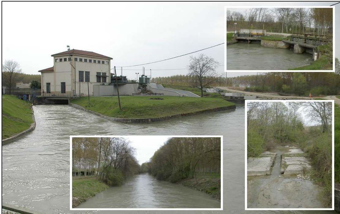
Figura 5.5.6 - Impianto Enel e, nei riquadri, particolari dei canali di servizio.
