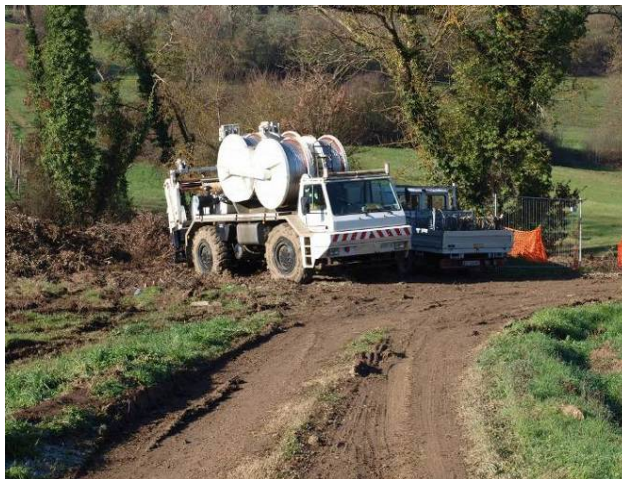
Figura 4.3 - Postazione di lavoro per tesatura conduttori e per la stesura della corda pilota
