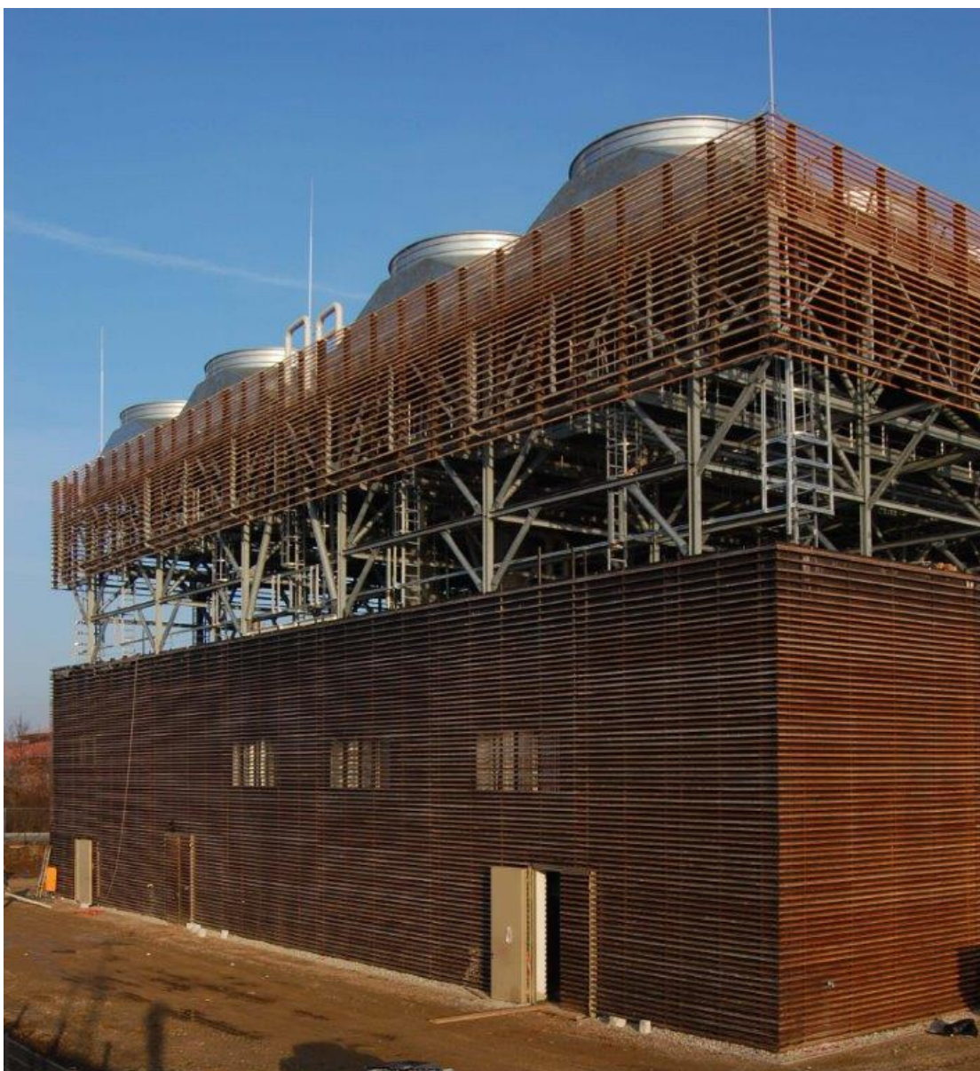
Figura 4-2 Centrale geotermoelettrica ORC di Sauerlach (Germania) (fonte: Turboden Italia)
