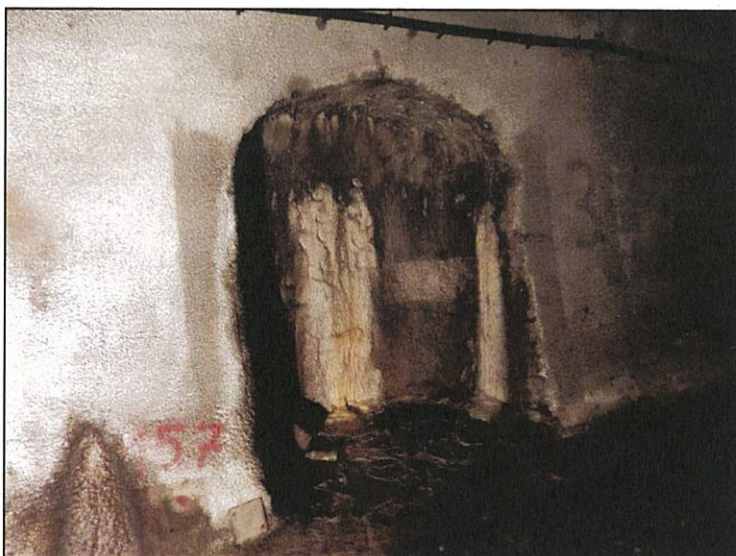
Foto 26. Venute d'acqua e concrezioni (lato sinistro) pk rel. 455 m
