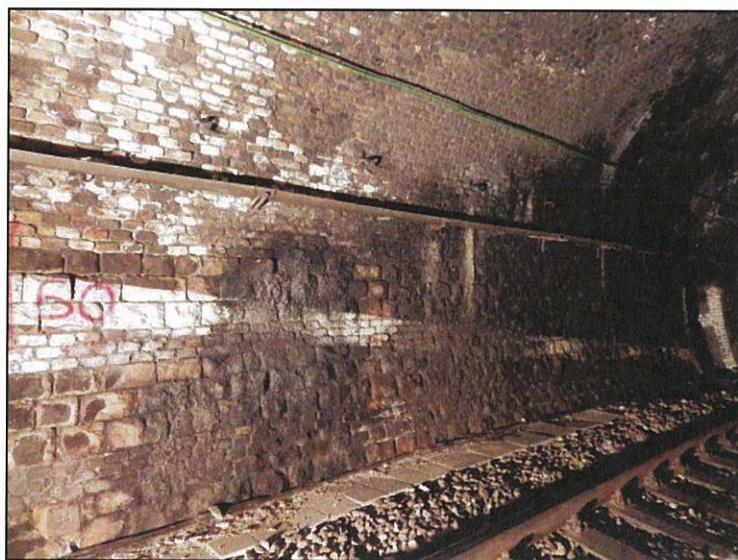
Foto 23. Rivestimento umido e stillicidi pk rel. 55 m
