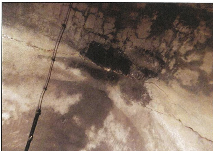
Foto 15: Umidità diffusa e laterizi alterati pk rel. 40 m
