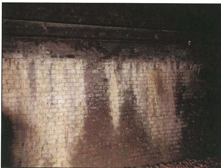
Foto 8. Concrezioni e venute d'acqua pk rel. 45 m
