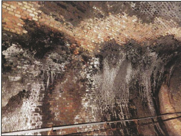
Foto 11. Lesione nel rivestimento in laterizi (piedritto sinistro) pk rel. 142 m
