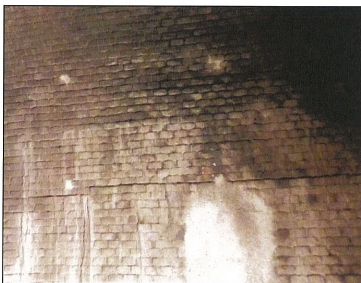
Foto 27. Lesione sub-orizzontale (rene destro) pk rel. 520 m
