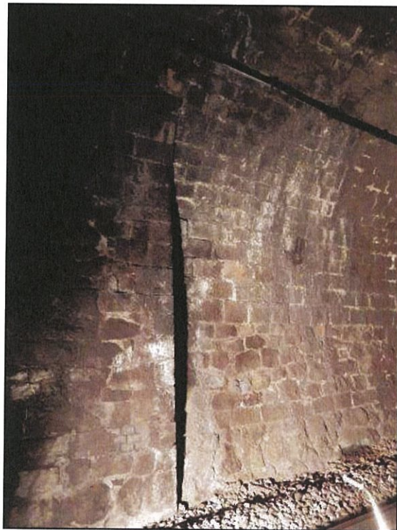
Foto 21. Cambio di sezione (piedritto sinistro) pk rel. 308
