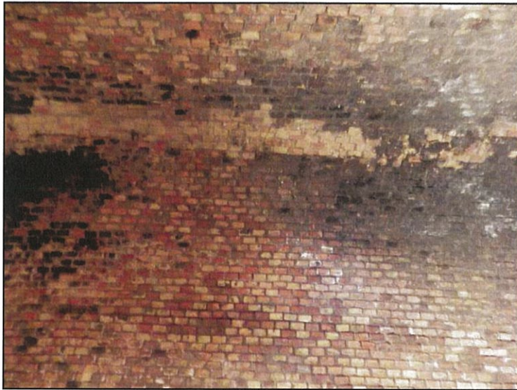
Foto 4. Laterizi fortemente alterati e privi di malta (calotta) pk rel. 150 m
