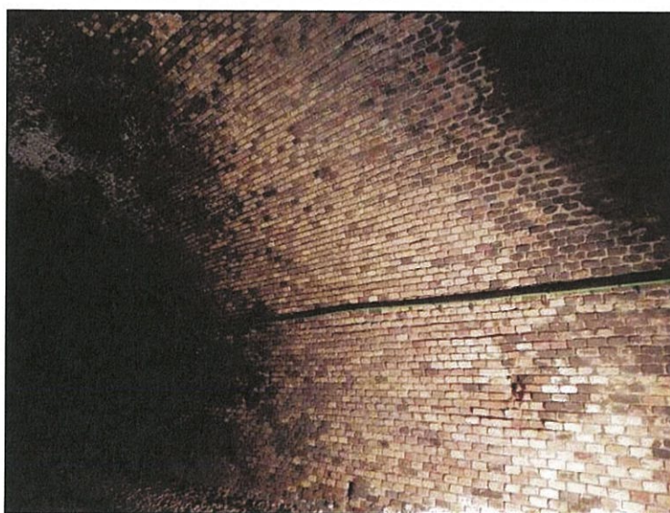
Foto 16. Umidità diffusa e laterizi alterati (piedritto/rene destro) pk rel. 345 m
