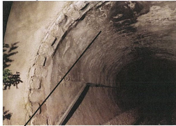
Imbocco galleria. Chiazze di umidità sporadiche
