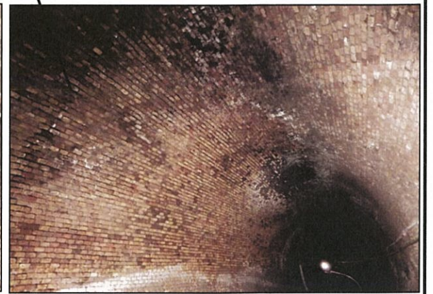
Frattura nel rivestimento
