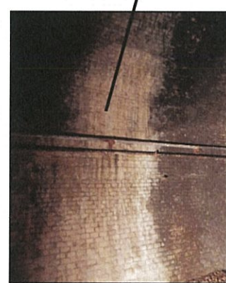
Settore umido con concrezioni
