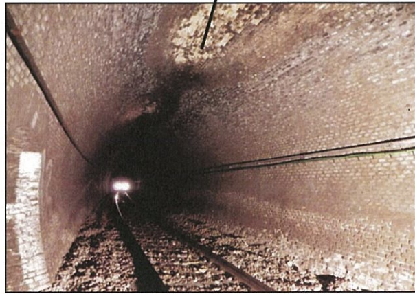
Rivestimento ammalorato\ settore umido
