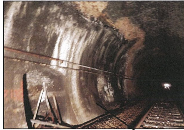
Settore umido con concrezioni e venute d'acqua
