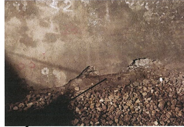
Distacco rivestimento con esposizione armatura
