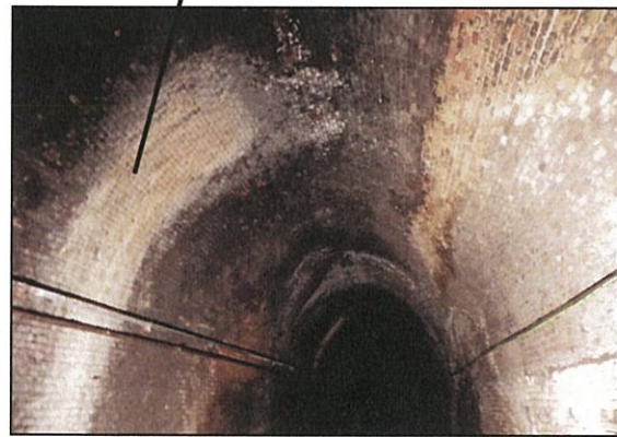
Settore umido con concrezioni
