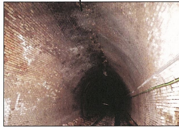
Rivestimento ammalorato|settore molto umido
