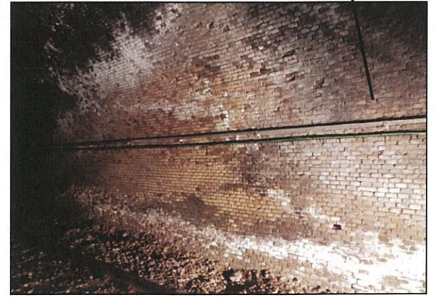
Settore particolarmente umido
