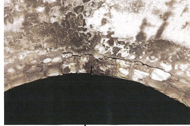
Distacco dello spritz dalla callotta all'imbocco
