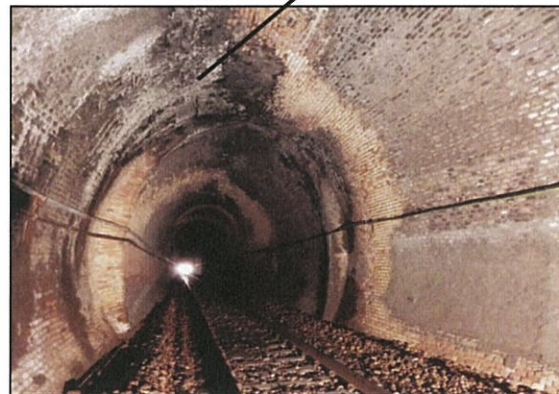
Settore umido con concrezioni e venute d'acqua
