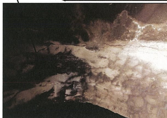
Frattura nel rivestimento lungo tutta la sez. della galleria
