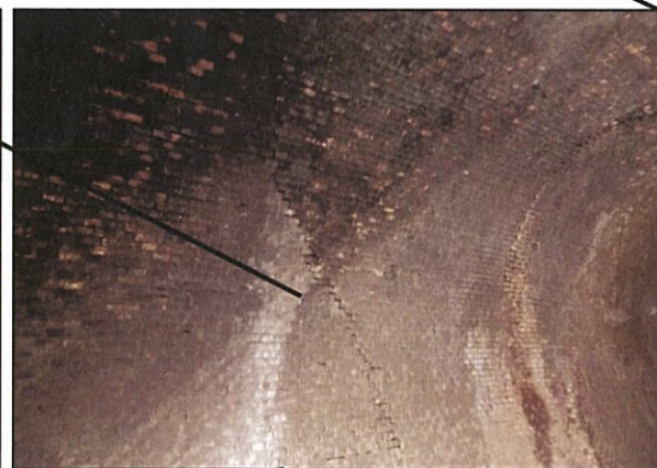
Frattura nel rivestimento
