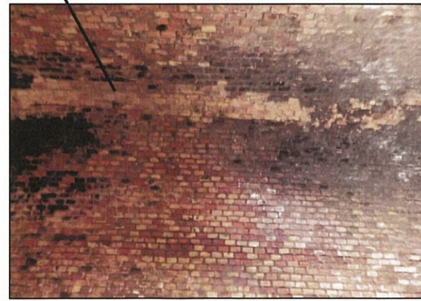
Laterizi ammalorati privi di malta
