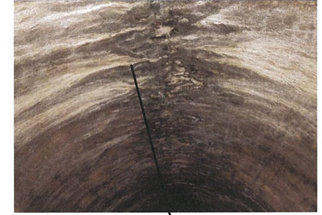
Settore di rivestimento molto alterato per forte umidità
