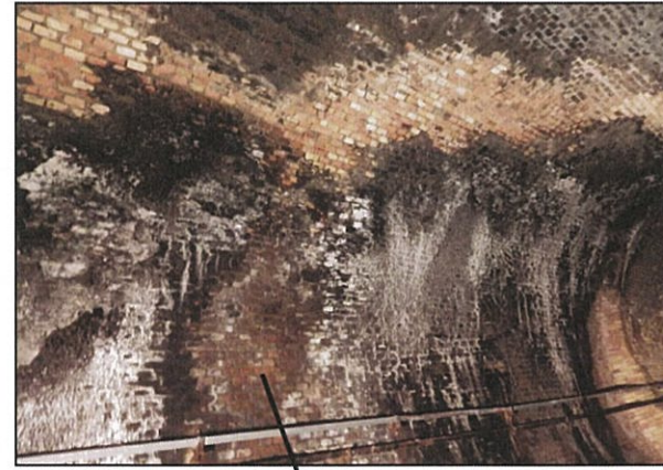
Settore particolarmente ammalorato con laterizi privi di malta
