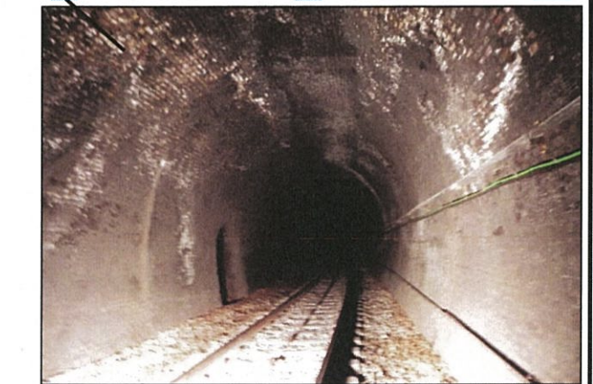
Rivestimento ammalorato\ settore umido
