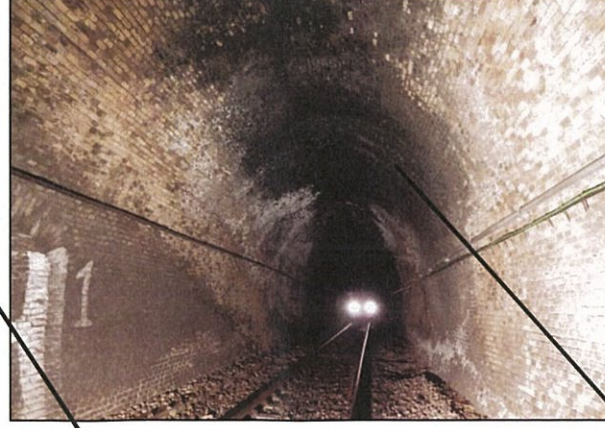
Settore particolarmente umido
