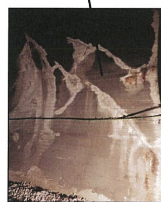
Fratture nel rivestimento in cls
