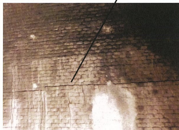
Particolare della lesione tra i mattoni parzialmente aperta
