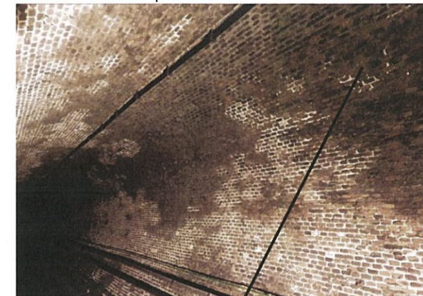
Settore di calotta più umido e ammuffito
