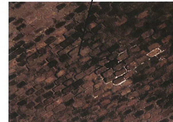
Settore di calotta con leggero ammaloramento superfic.
