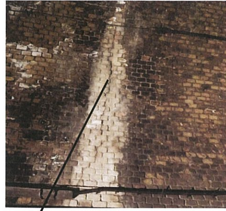
Fessura tra i mattoni a cavallo della concrezione
