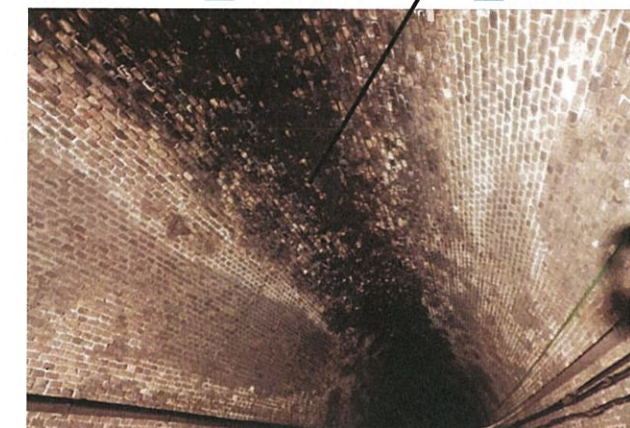
Settore di calotta particolarmente umido
