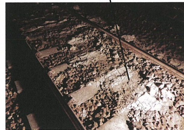
Traversine ricoperte parzialmente di fango essiccato
