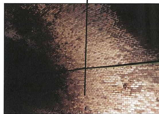
Settore ammalorato con umidità
