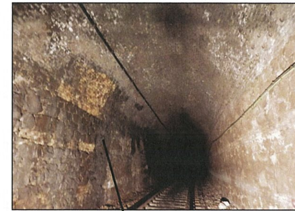
Settore ammalorato ed umido con diffuse venute d'acqua
