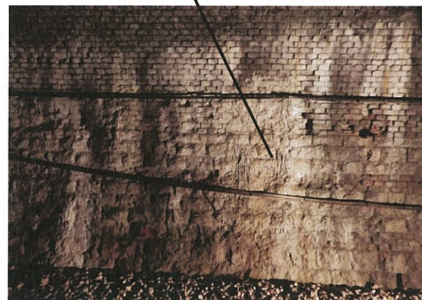
Area con muffa debolmente concrezionata
