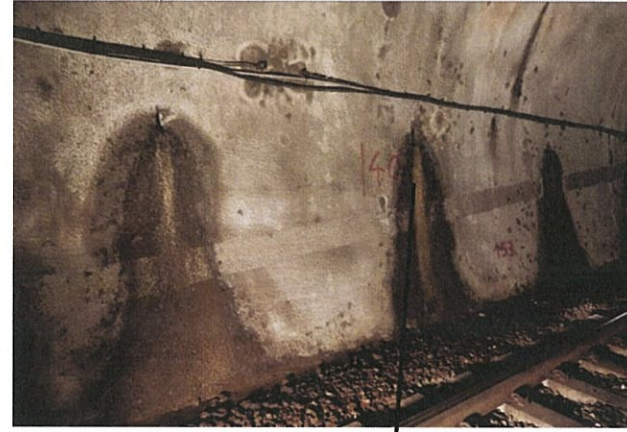
Venute d'acqua e concrezioni dalle calalette drenanti
