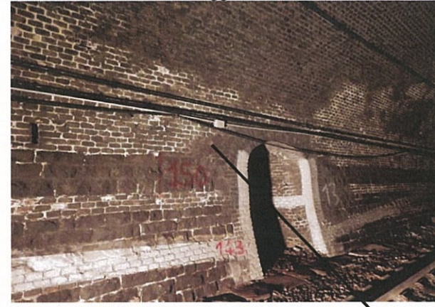
Settore di rivestimento leggermente umido ma sano
