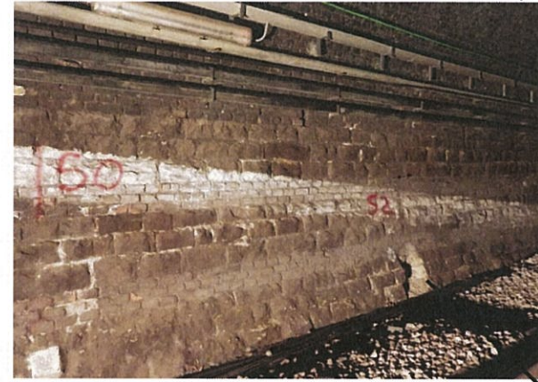
Rivestimento danneggiato (mancanza di blocchi al piede)
