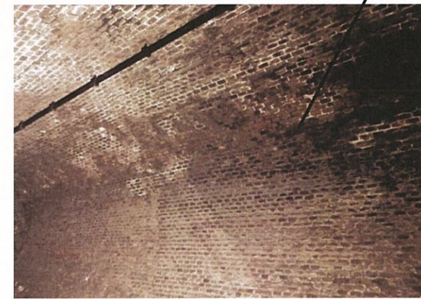
Settore di calotta più umido e ammuffito
