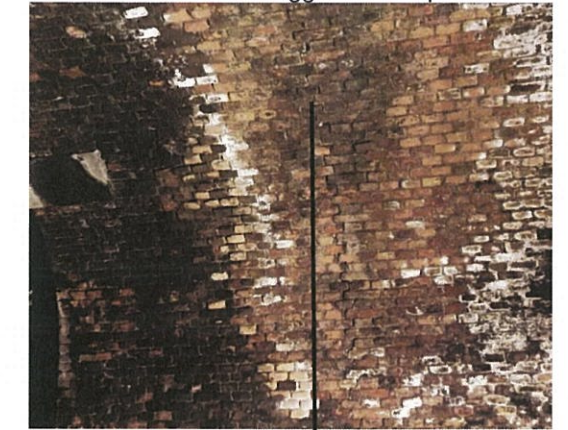
Fessura tra i mattoni leggermente aperta
