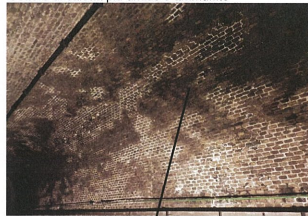
Settore di calotta più umido e ammuffito
