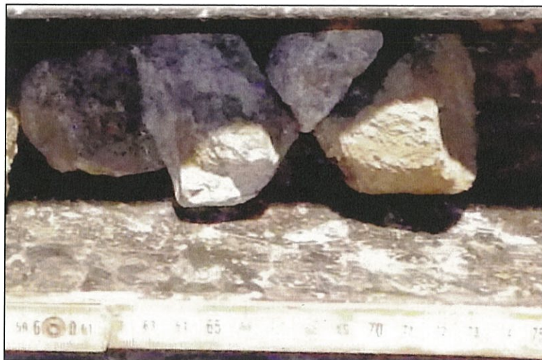
Artificiale Leonessa pk 55+200. Dettaglio contatto rivestimento/substrato
