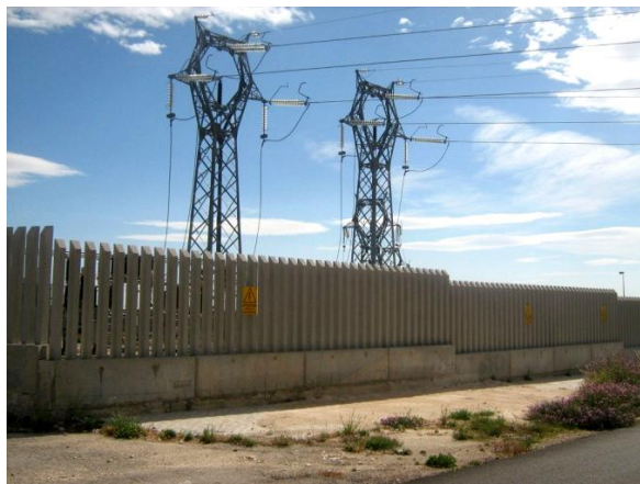
Foto 4: La stazione elettrica CP Troia in località Deserta
