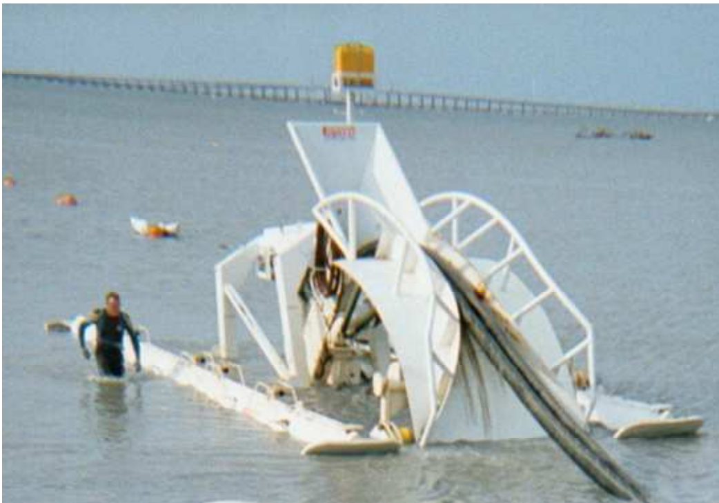
Fig. 9 Sistemi a getto per l'interramento di cavi sottomarini ( h > 10 ): Hydroplow (Prysmian Proprietary).
