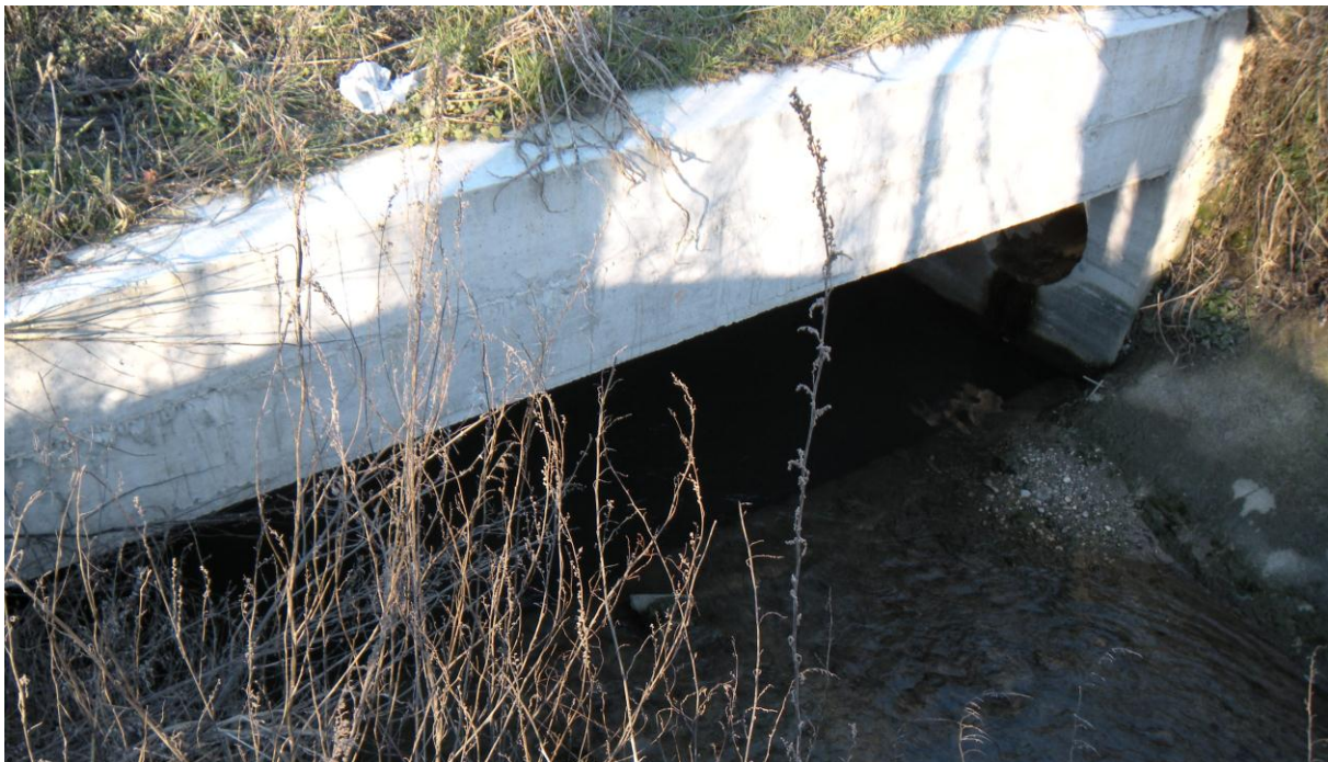
Figura 1. Vista in piena e in magra dell'imbuco del manufatto di attraversamento della SR 14. Nell'immagine sotto si riconosce chiaramente il salto di fondo e il volume morto di acqua presente nella configurazione attuale. Per tale motivo, in piena risulta estremamente facile l'innalzamento dei livelli fin quasi alla sommità della luce.
