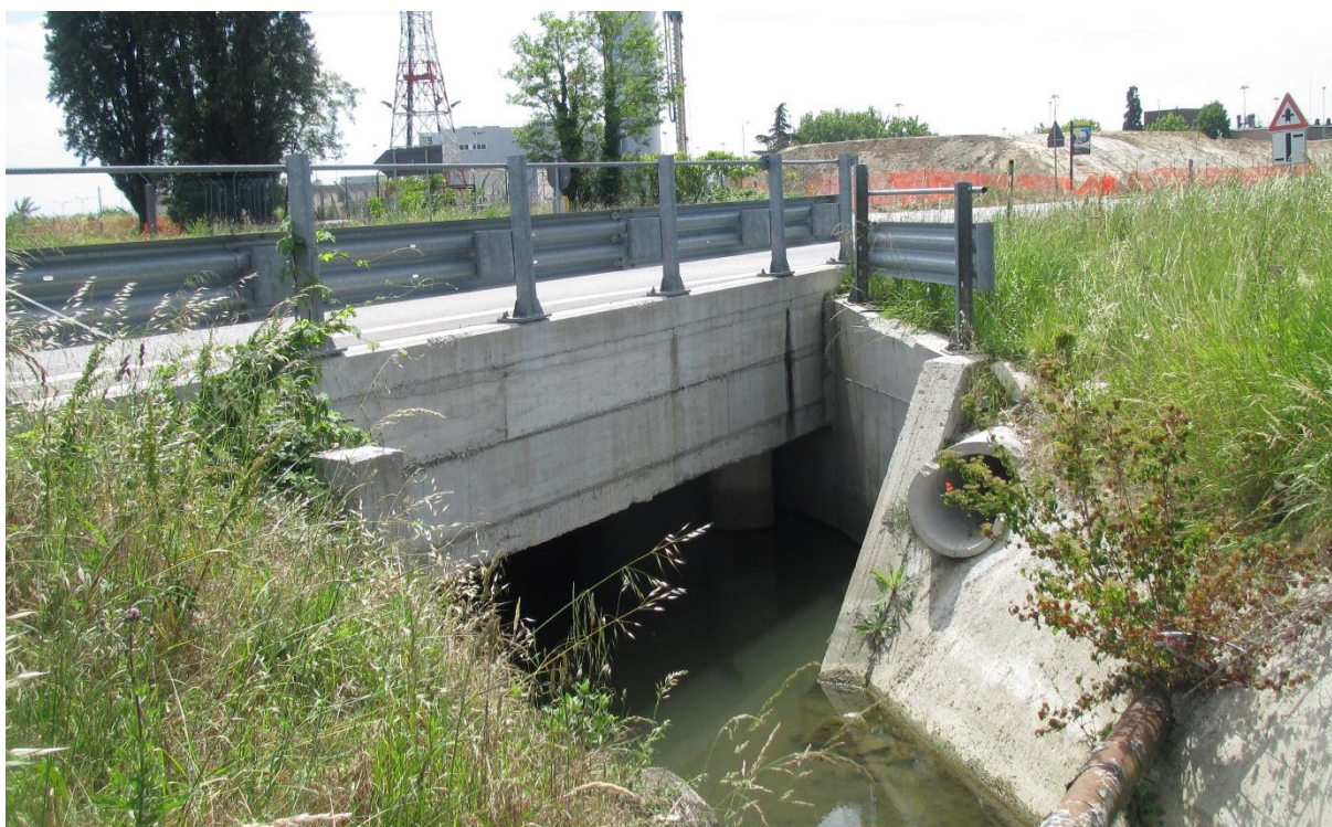
Figura 6.1. Vista dell'imbocco del manufatto di attraversamento della SR 14. Nell'immagine sotto si riconosce chiaramente il salto di fondo e il volume morto di acqua presente nella configurazione attuale. Per tale motivo, in piena risulta estremamente facile l'innalzamento dei livelli fin quasi alla sommità della luce.
