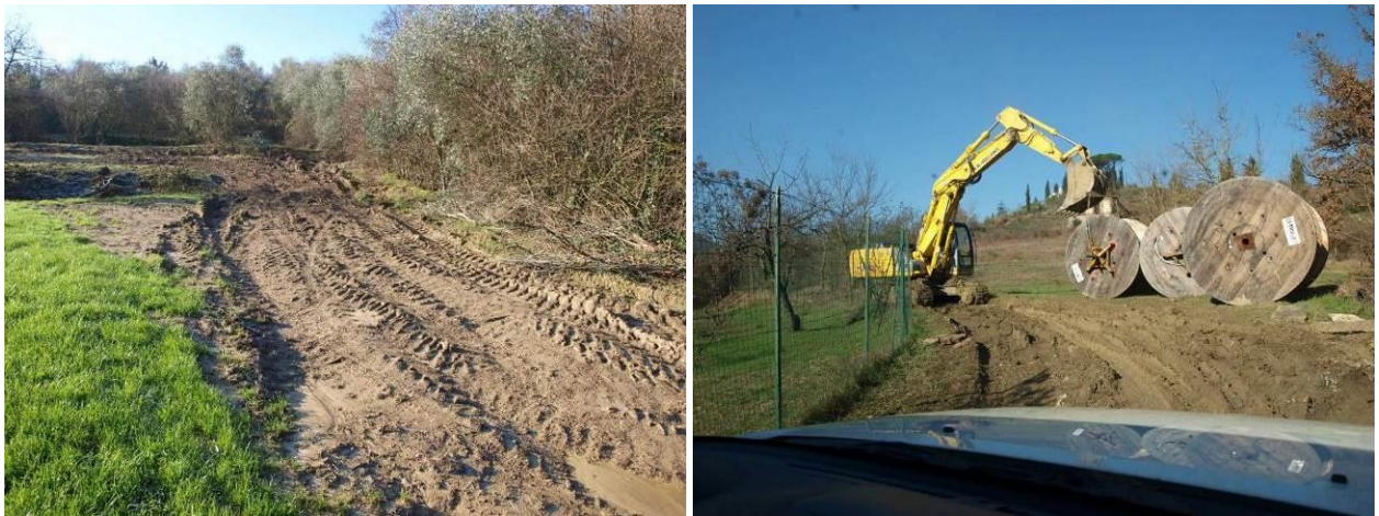
Figura 7.11 - pista di accesso ai microcantieri dei nuovi tralicci (sx) e trasporto dei conduttori tramite piste temporanee (dx)
