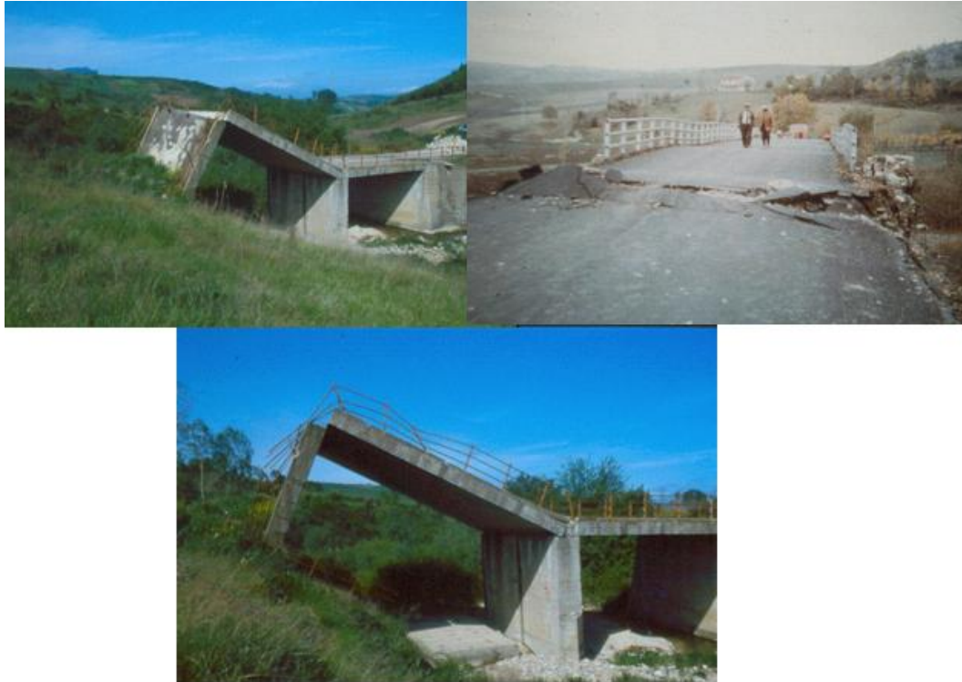
Valle del T. Fredane: riattivazione di dissesti ed effetti sui viadotti
