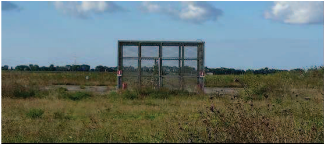
Figura 3-2 Ripresa fotografica Area Pozzo Agosta 1 dir - particolare della testa pozzo protetta da gabbionatura
