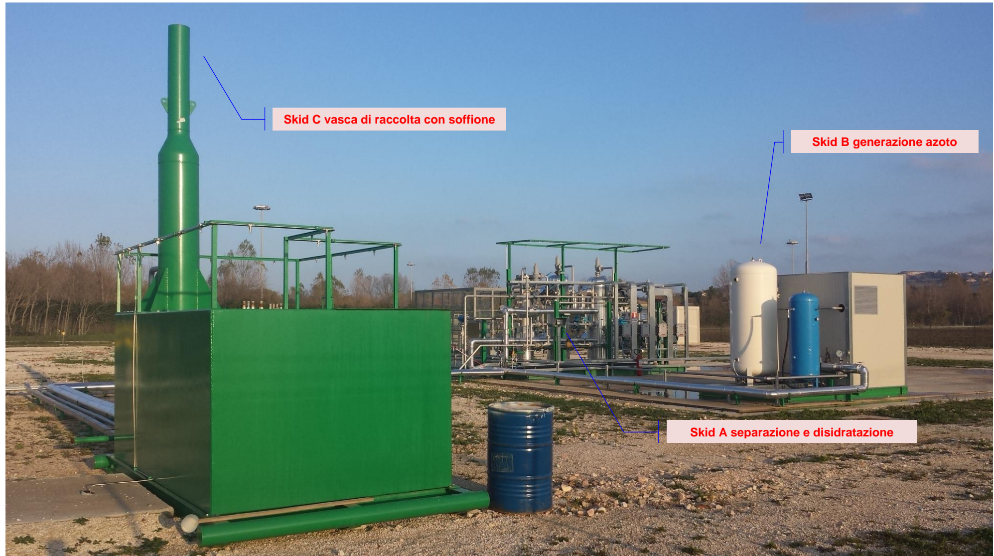
Foto 2E: Impianto tipo
