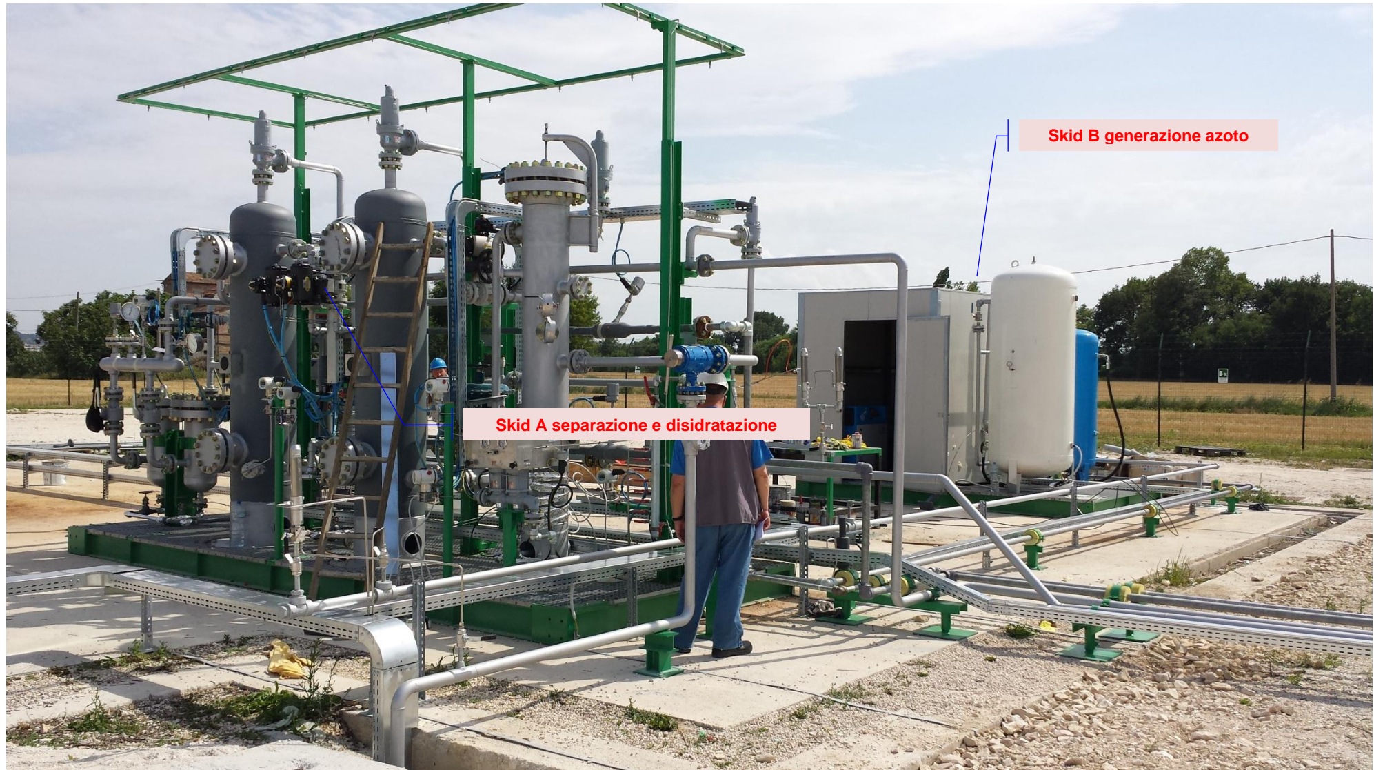
Foto 3E: Impianto tipo
