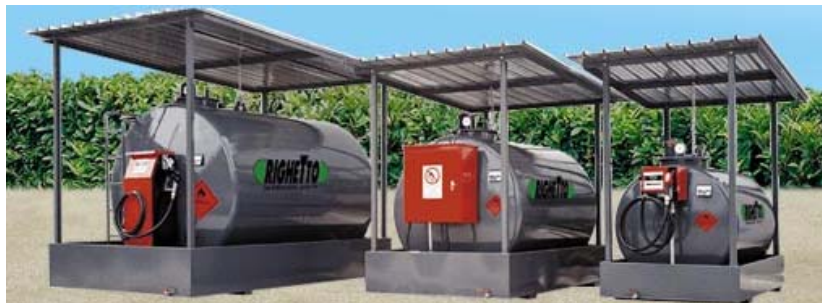
Abbildung 23: Beispiel für Treibstoff-Verteileranlage
