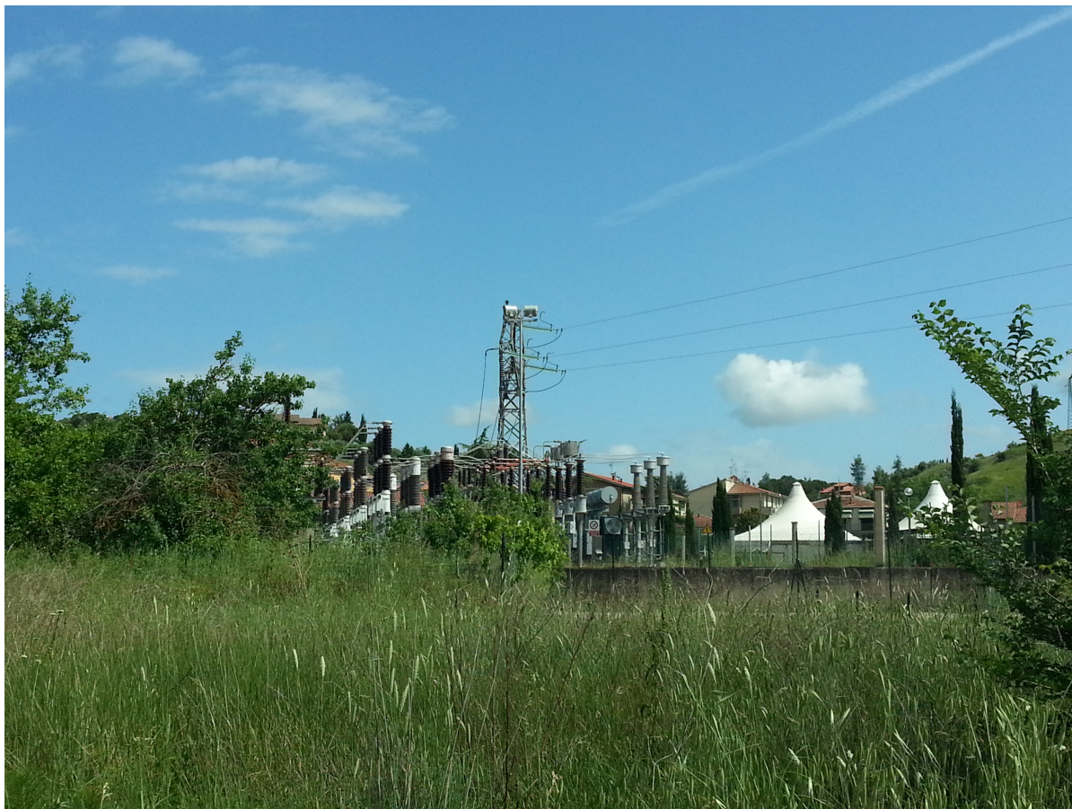
Figura 1 – Cabina primaria ENEL di Saline di Volterra
