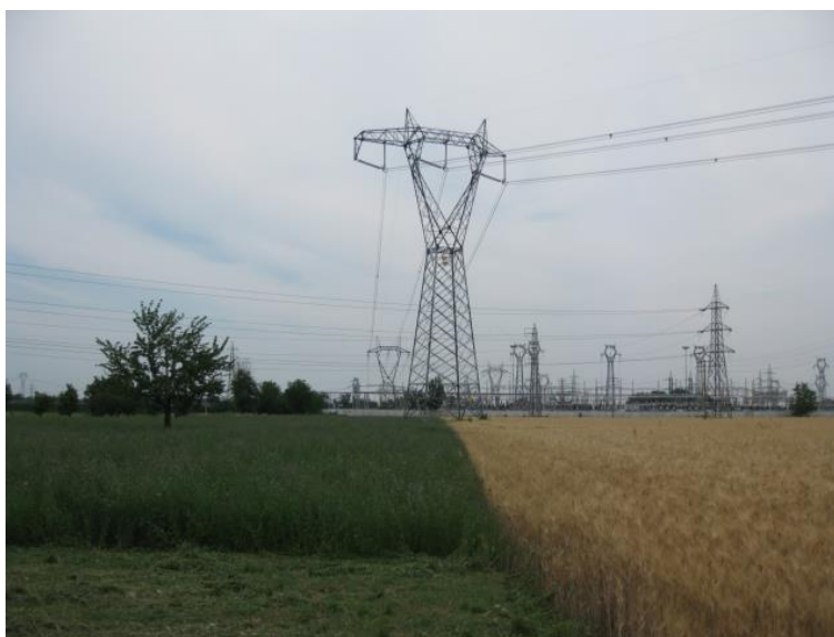
Foto 40 - Stazione elettrica di Rubiera
