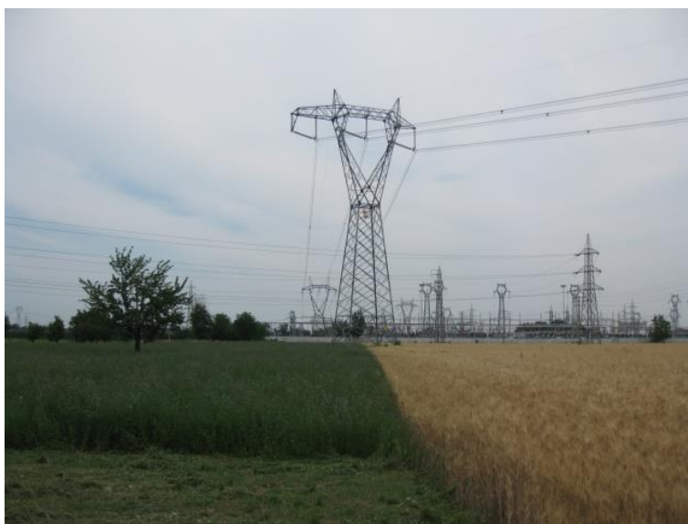
Foto 40 - Stazione elettrica di Rubiera
