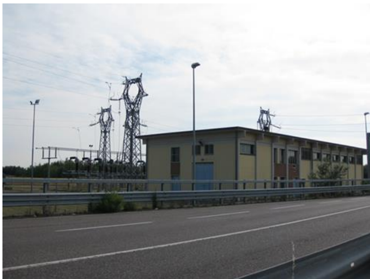
Foto 1 – Cabina primaria di Boretto
