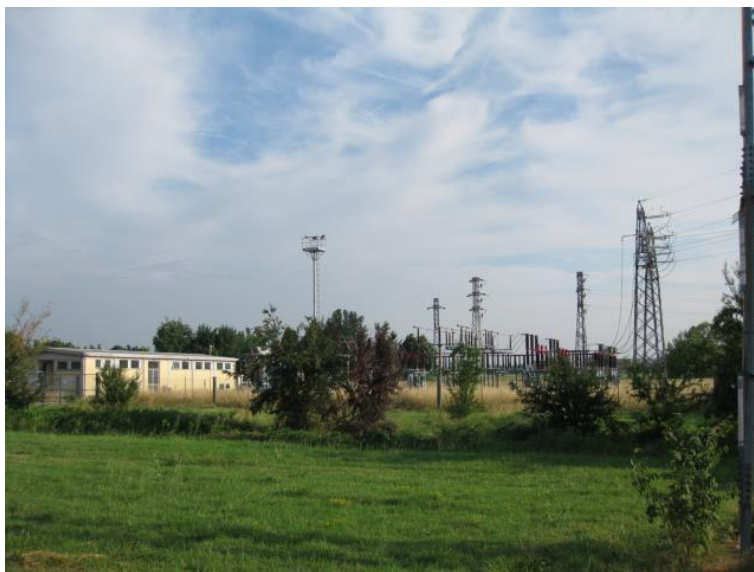
Foto 14 - Stazione elettrica di Castelnovo di Sotto
