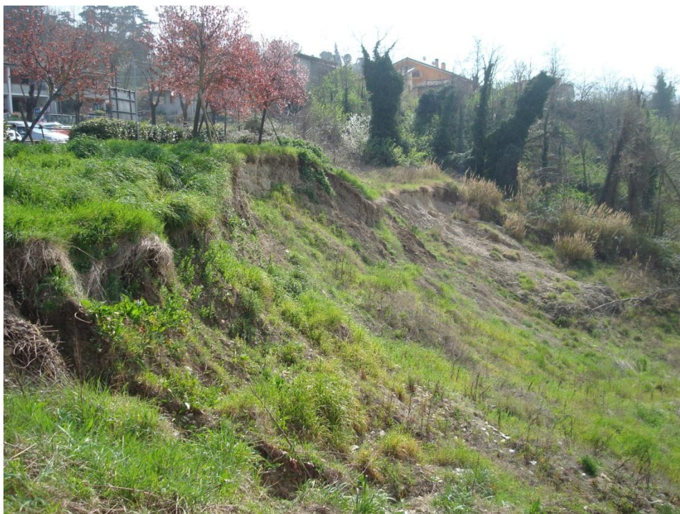
Foto 10- Particolare del dissesto in evoluzione al margine del parcheggio pubblico "Zaganti" a Ponte Verucchio.
