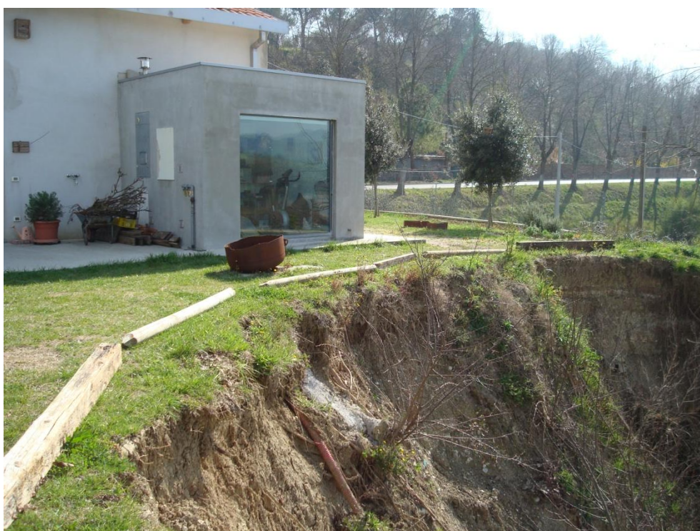
Foto 6- Corona del dissesto in prossimità dello spigolo Sud dell'edificio. Il dissesto non interessa sottoservizi e linee di pertinenza (in primo piano una guaina in plastica rossa di protezione dei cavi elettrici dell'impianto di illuminazione del giardino esterno).
