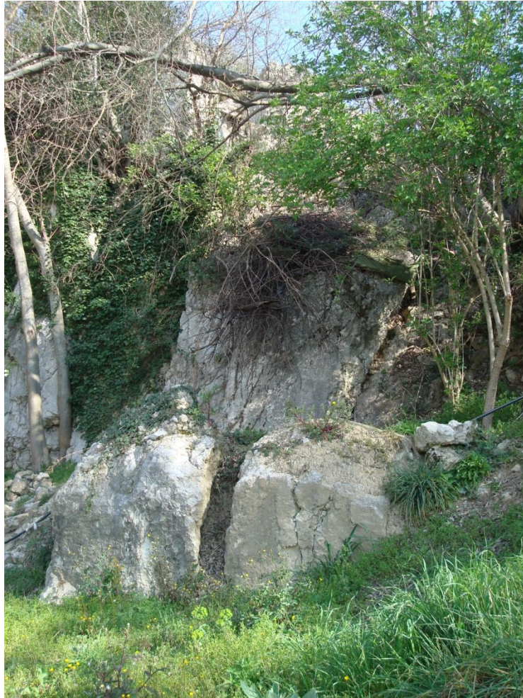
Foto 3 - Particolare di alcuni massi calcarei fratturati e disarticolati
