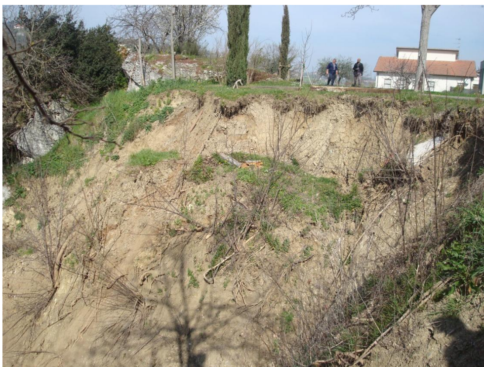
Foto 8- Particolare della porzione sommitale del dissesto. Sulla sinistra i massi calcarei del contrafforte saldo.
