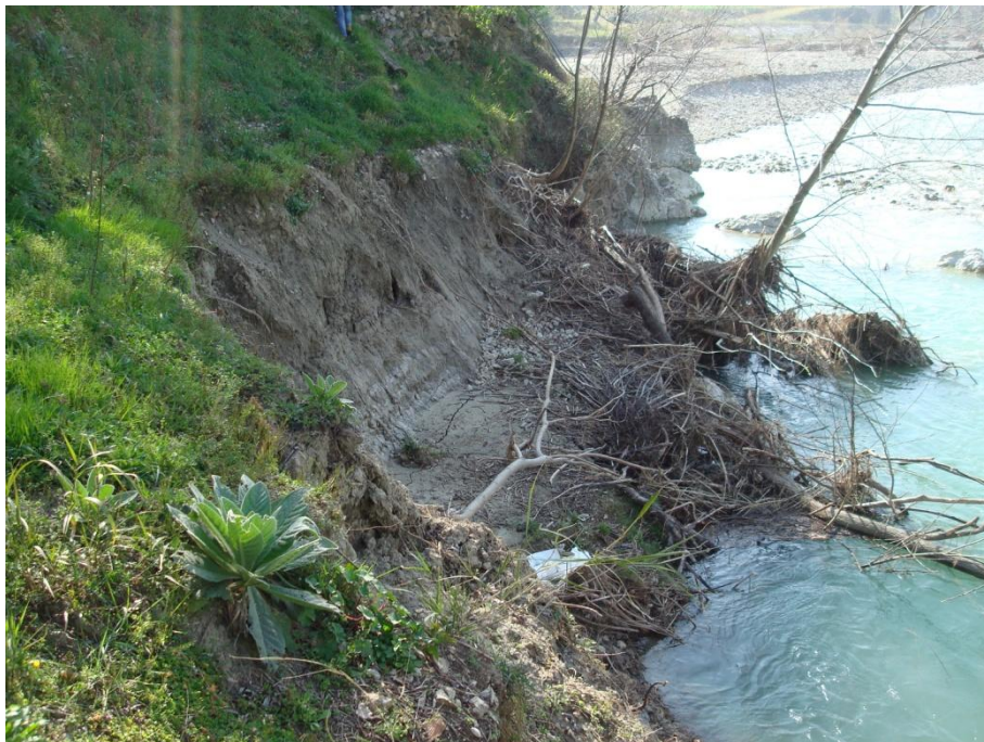
Foto 4 – Erosione di sponda alla base del contrafforte calcareo
