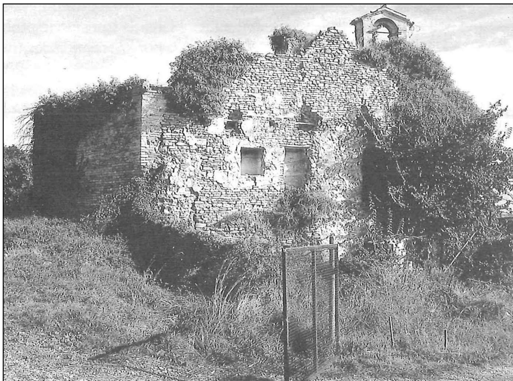
Figura 34. Ruederi della ex Pieve di San Lorenzo "in Strada" (SCHEDA n. 34. Da Furiassi 1996).
