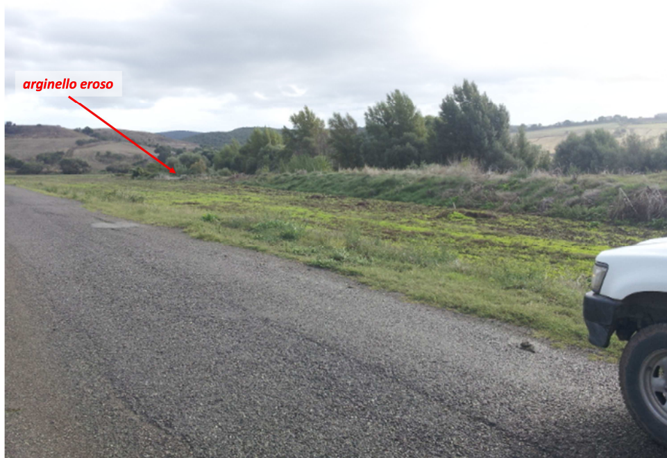
Figura 7.8. Zone in erosione in corrispondenza della sezione n. 420
