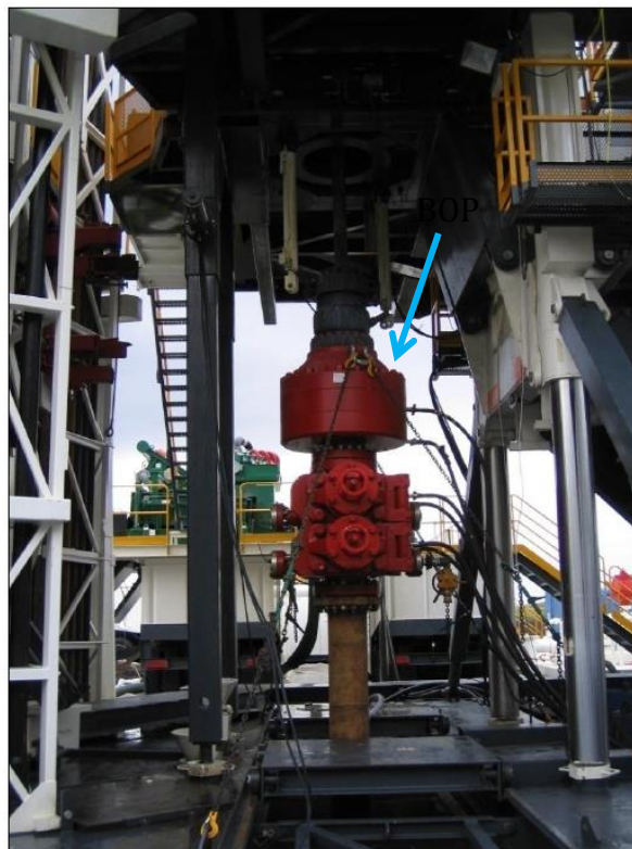
Figura 3-17. BOP montato su testa pozzo.
