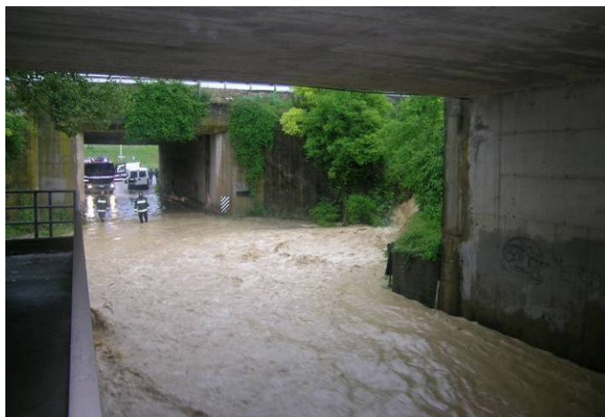
Foto 7 - Fosso di Poggio Orlando - vista del sottopasso della ferrovia e della superstrada (evento maggio 2013)
