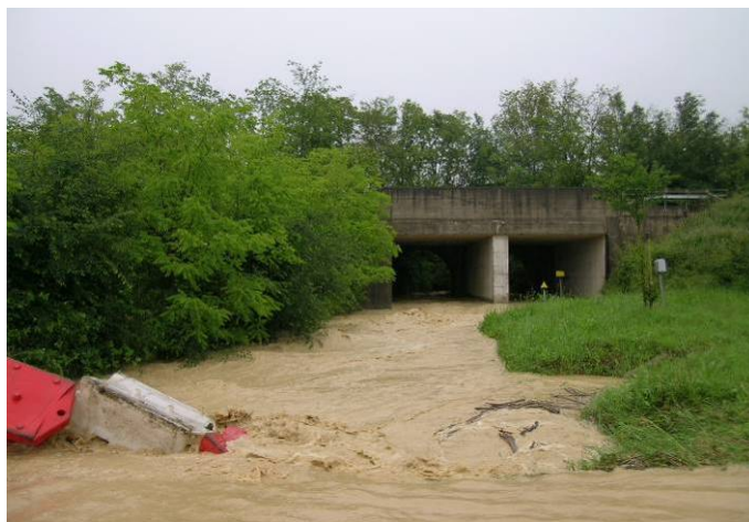
Foto 1 - Fosso Massimina - vista dell'attraversamento ferroviario del dall'attraversamento stradale di Via della Resistenza (evento maggio 2013)
