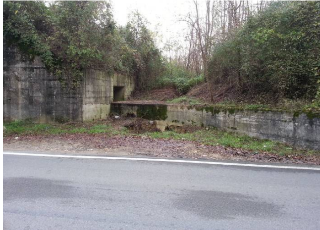
Foto 9 - Fosso di Poggio Orlando vista del pozzetto di sbocco della scatolare di sottopasso superstrada e inizio del tratto tombato d.800mm
