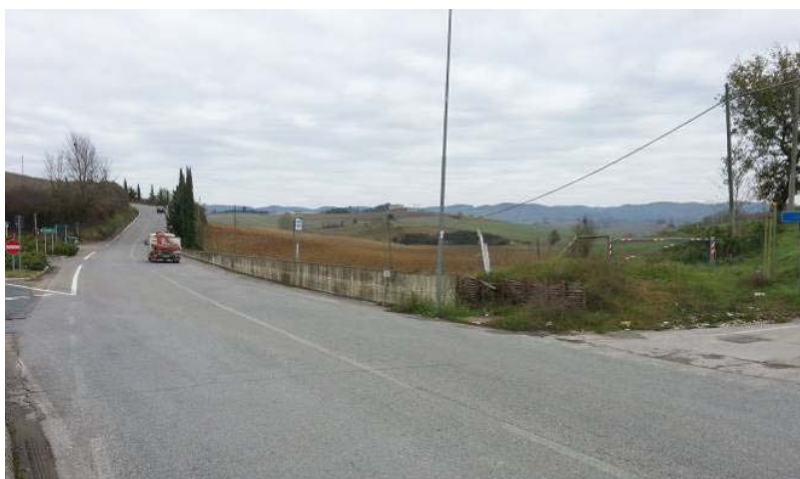
Foto 12 - Fosso Massimina -Vista del muro di coronamento della cassa di espansione dalla SP 119 di Lornano
