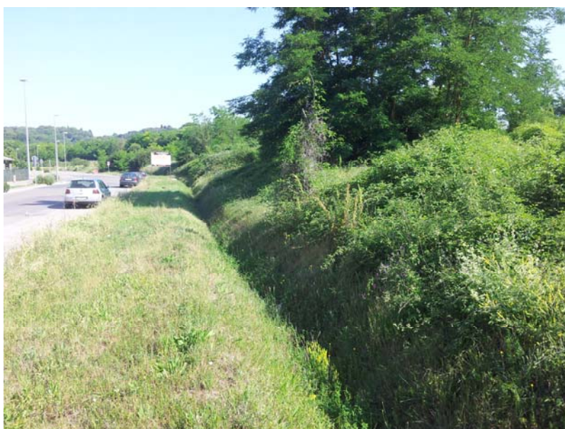
Foto 18 - vista della scolina esistente parallela a Via della Resistenza da adeguare allo stato di progetto
