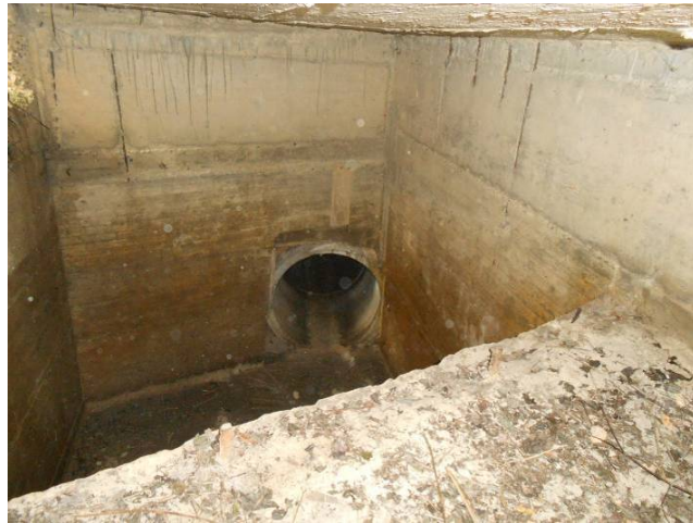
Foto 10 - Fosso di Poggio Orlando - vista interno pozzetto di imbocco del tratto tombato d.800 mm
