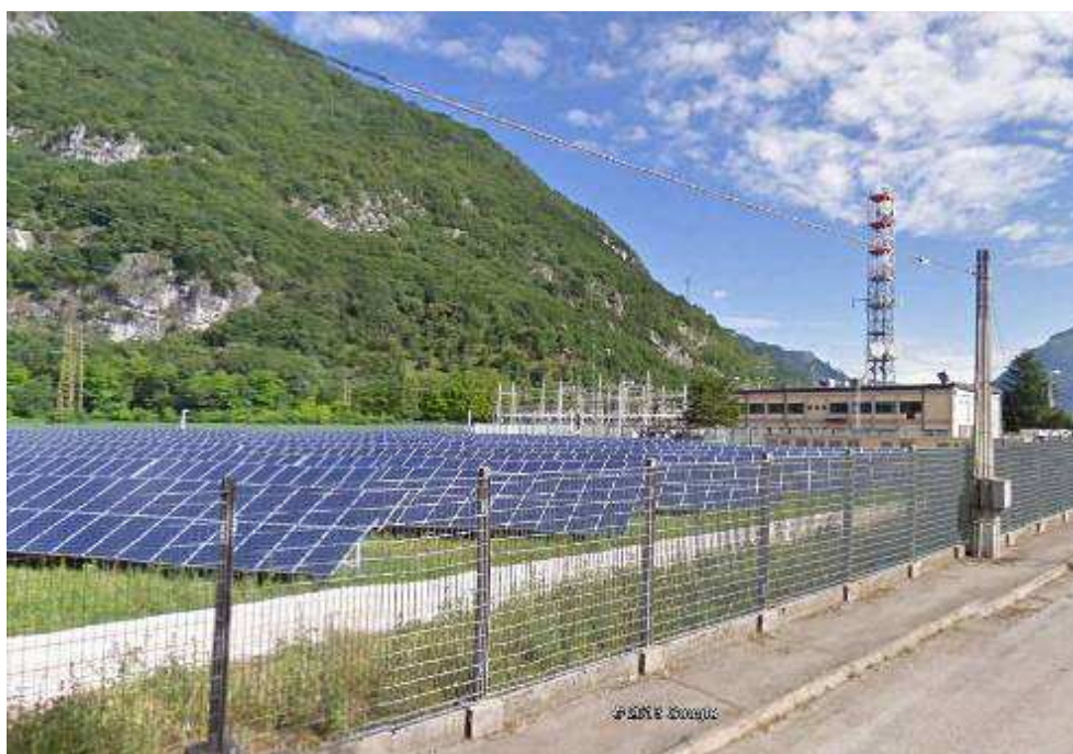
Stazione elettrica esistente
