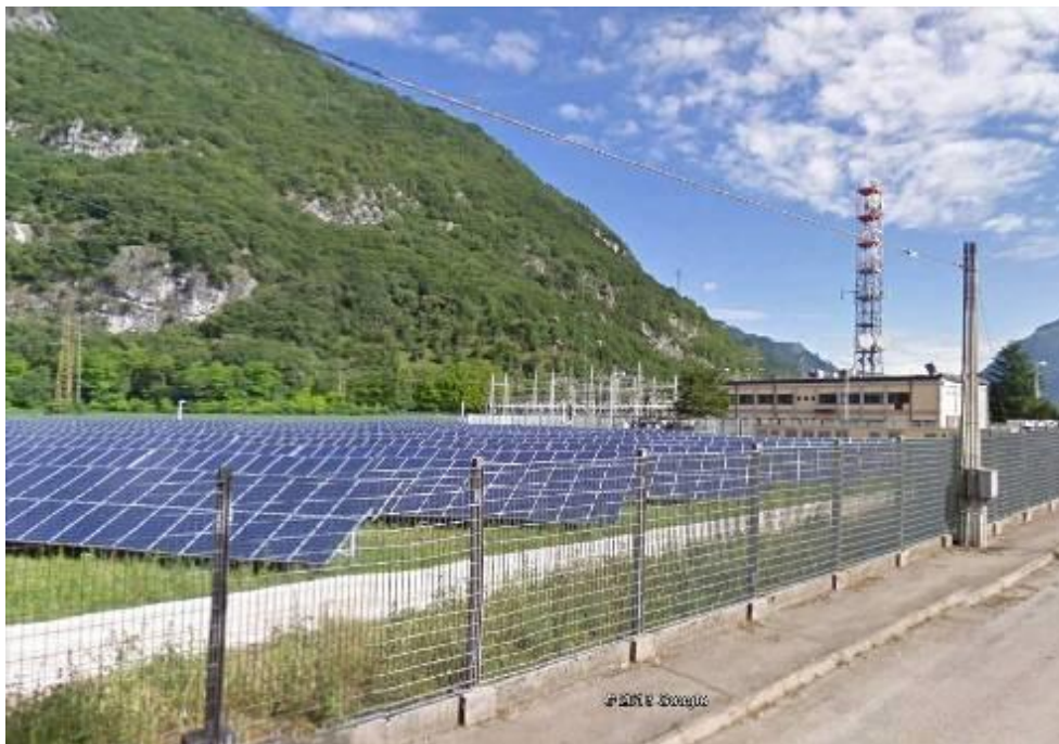
Figura 11: Stazione elettrica esistente
