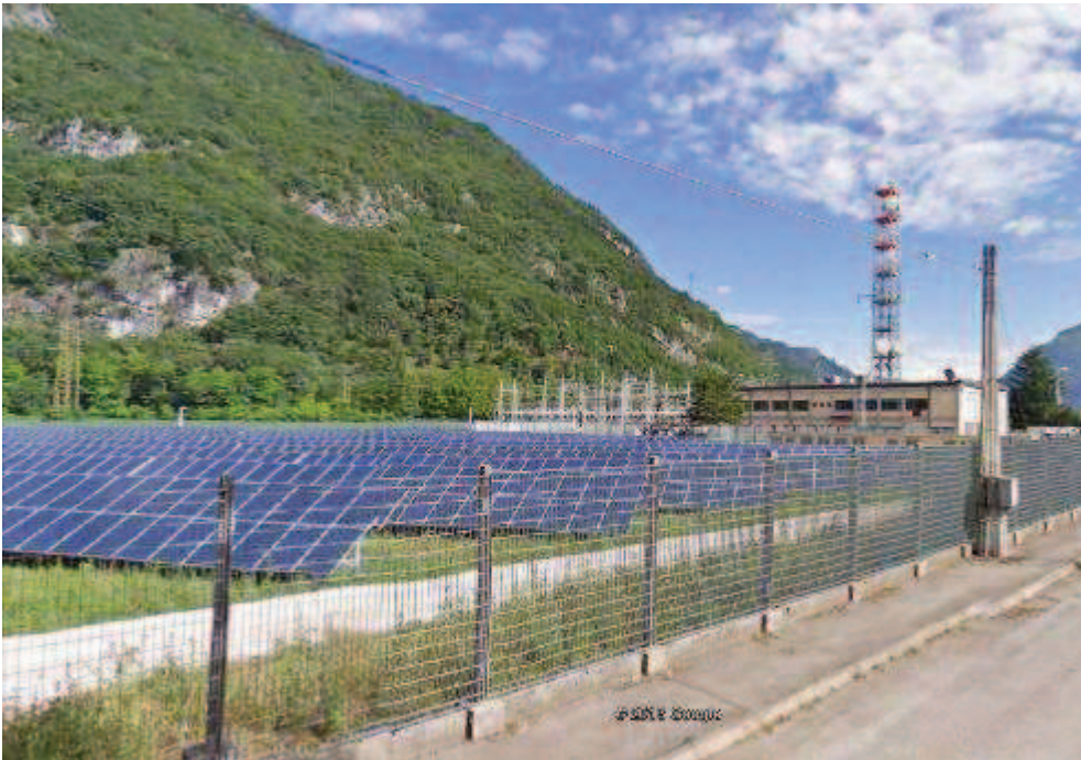
Figura 2-33. Stazione elettrica esistente.
