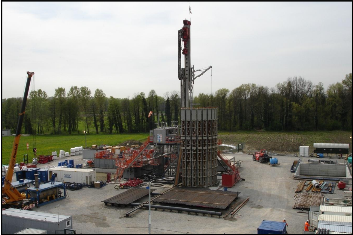
Figura 4.3.5.1b Esempio di Impianto di Perforazione con Potenzialità 3.000 m
