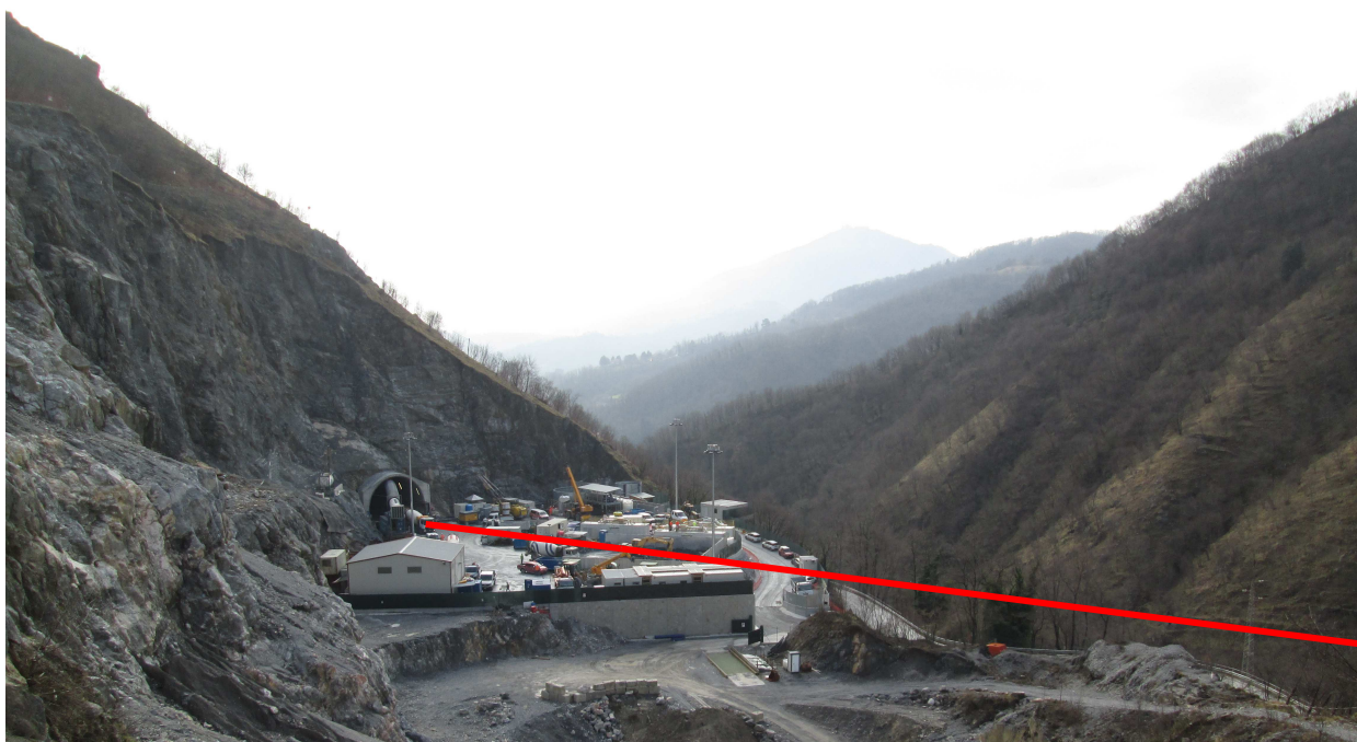
Figura 6-1 Area di cantiere dalla quale si svilupperà il nastro trasportatore previsto in II FASE
