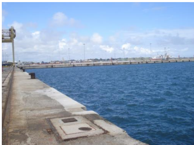
Pozzetto di arrivo del terminale in area A.P.
