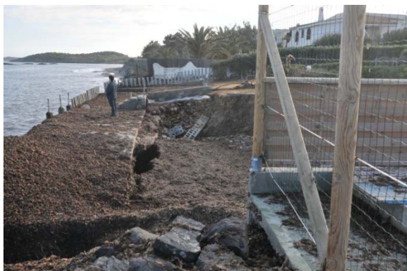
Figura 7 Fenomeni di crollo e smantellamento degli edifici localizzati a ridosso della spiaggia di Perd'e Sali interessati dall'azione erosiva dei frangenti.
