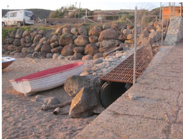
Figura 5 Particolare della massicciata realizzata a protezione e contenimento dell'infrastruttura viaria e dell'area sosta sovrastante, con canale di raccolta e scolo delle acque meteoriche. Scivolo di alaggio e varo delle imbarcazioni. Tali elementi determinano un irrigidimento del sistema e un'interferenza sui naturali processi evolutivi della spiaggia.
