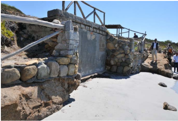
Figura 4 Esempio di una struttura rigida realizzata in ambito di spiaggia che costituisce un-chiaro elemento di interferenza sulle dinamiche marino-litorali.
