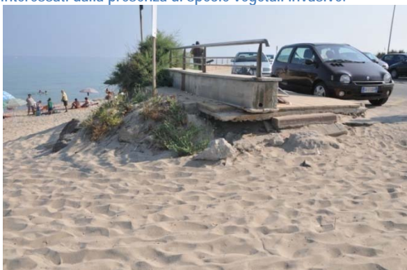
Figura 7 Fenomeni di scalzamento al piede e cedimenti del rilevato stradale nella sua parte terminale. La foto evidenzia in particolare come il rilevato stradale sia stato realizzato nell'ambito di sviluppo del compendio dunale.
