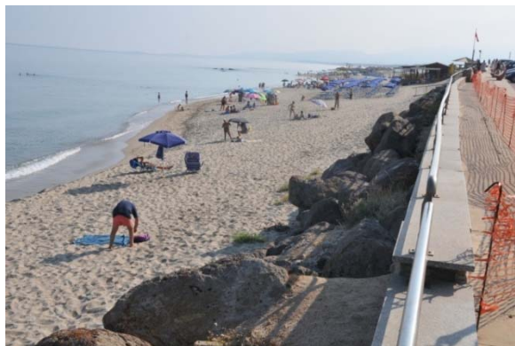
Figura 5 Particolare della massicciata posta a protezione del rilevato stradale la cui stabilità è compromessa dall'azione della dinamica meteo-marina.
