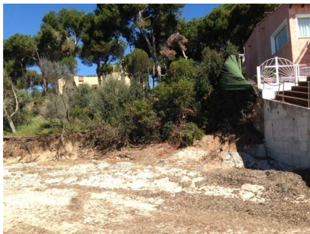
Figura 5 Evidenze dei processi erosivi della spiaggia e del sistema dunale ad opera del moto ondoso che stanno interessando gli edifici in essa insistenti.
