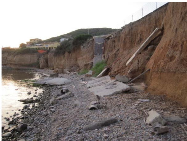
Figura 4 Ripa in erosione con interessamento dell'infrastruttura stradale sovrastante. Il naturale processo di arretramento risulta accentuato ed accelerato dalla inefficace regimazione delle acque meteoriche.
