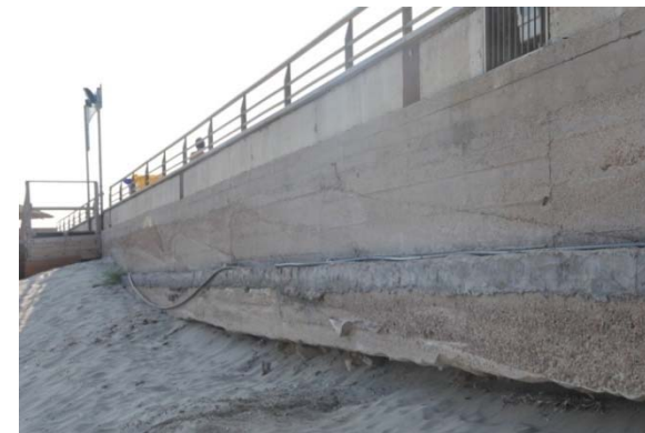
Figura 6 Fenomeni di scalzamento al piede del rilevato stradale per azione dei frangenti d'onda che stanno determinando cedimenti strutturali e crolli.
