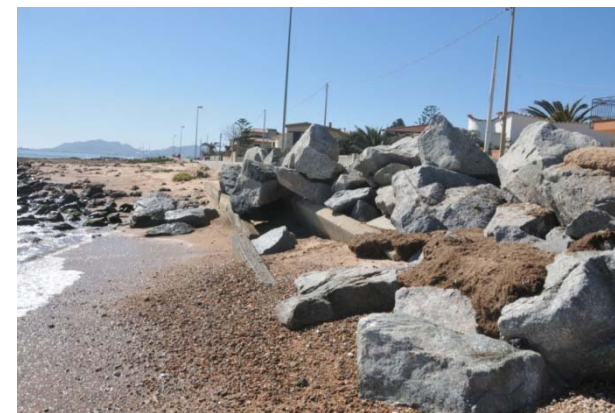
Figura 6 Scogliere radenti poste a protezione dell'infrastruttura stradale.
