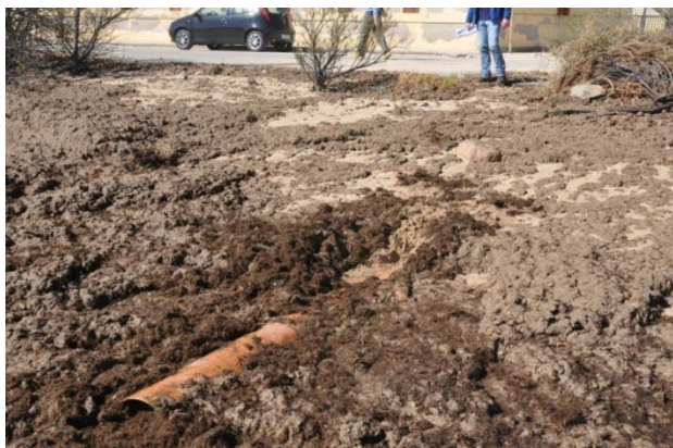
Figura 7 Le mareggiate hanno messo in luce la presenza, all'interno del corpo della spiaggia emersa residua, di tubi di scolo delle acque meteoriche provenienti dalle aree insediate.
