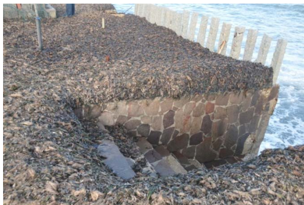
Figura 8 Particolare della scala di accesso di un'abitazione che risulta, a seguito del progressivo arretramento della linea di riva, a diretto contatto con l'azione erosiva del moto ondoso.
