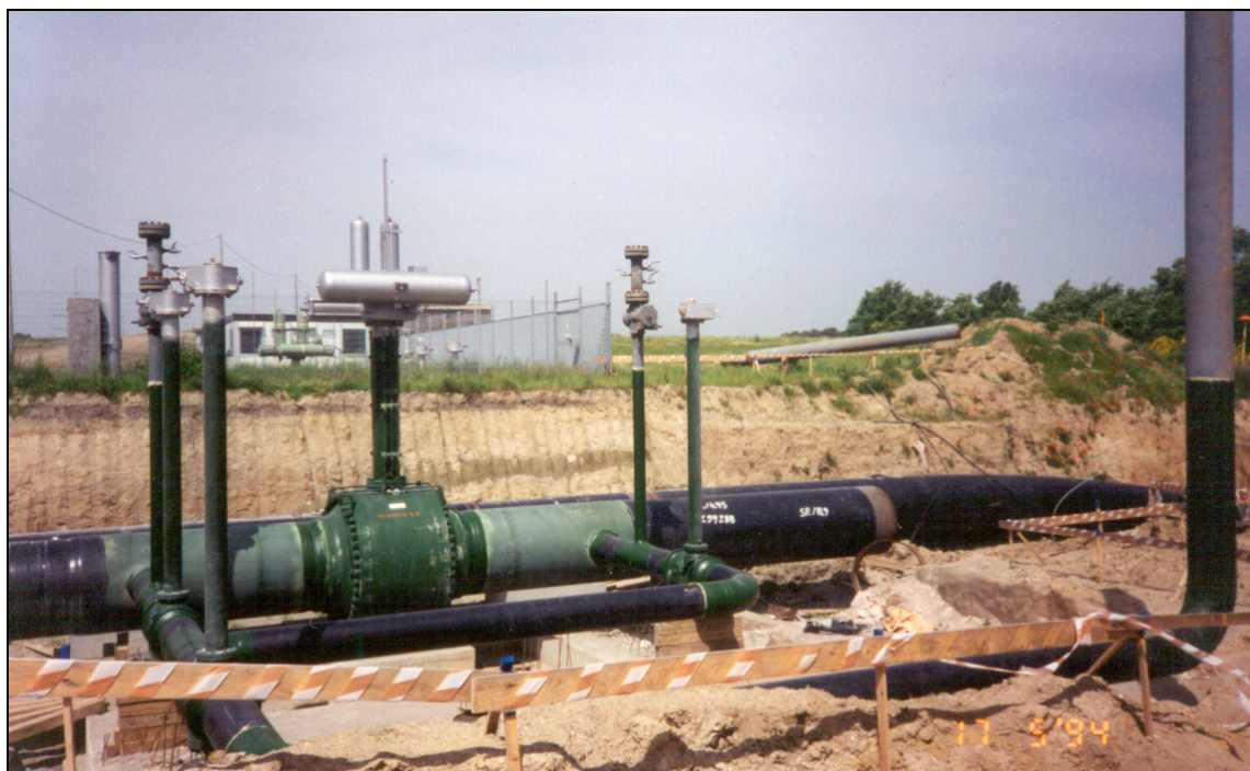
Foto 5.1/N: Impianto di intercettazione di linea (PIL)
