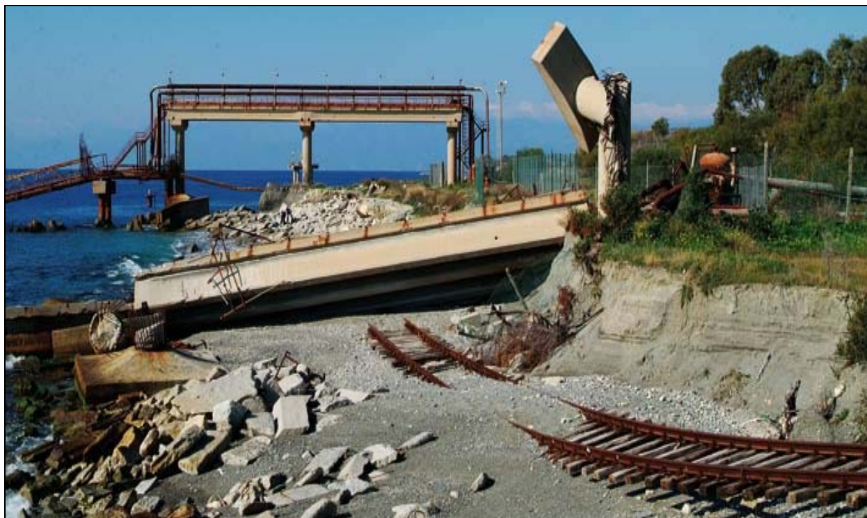
Figura 4: Stato di degrado dell'area
