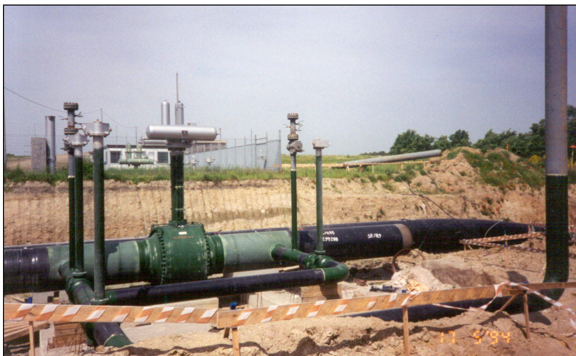
Foto 5.1/N: Impianto di intercettazione di linea (PIL)
