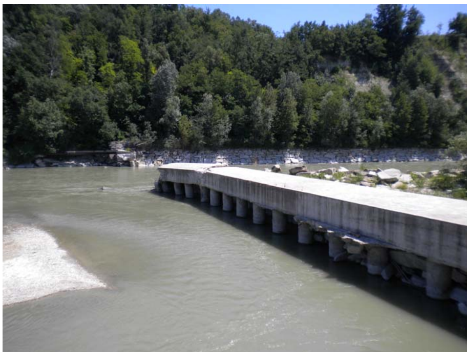
Fig. 3.2 Traversa esistente dopo il crollo del novembre 2010.
