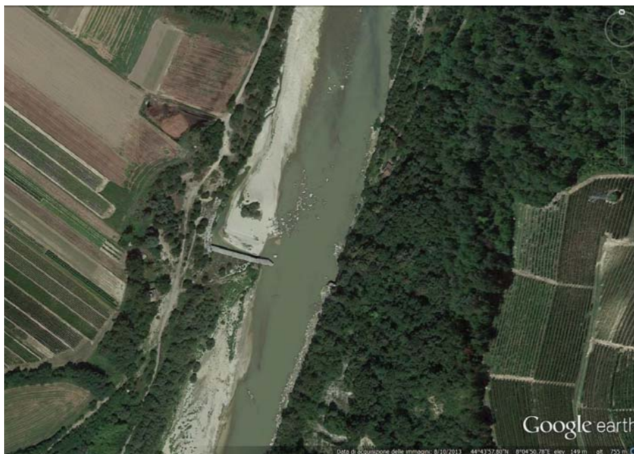
Fig. 1.3 Dettaglio della traversa esistente in evidente stato di dissesto a causa del crollo del novembre 2010. Fonte: Google Earth, 2013 (immagine non in scala).
