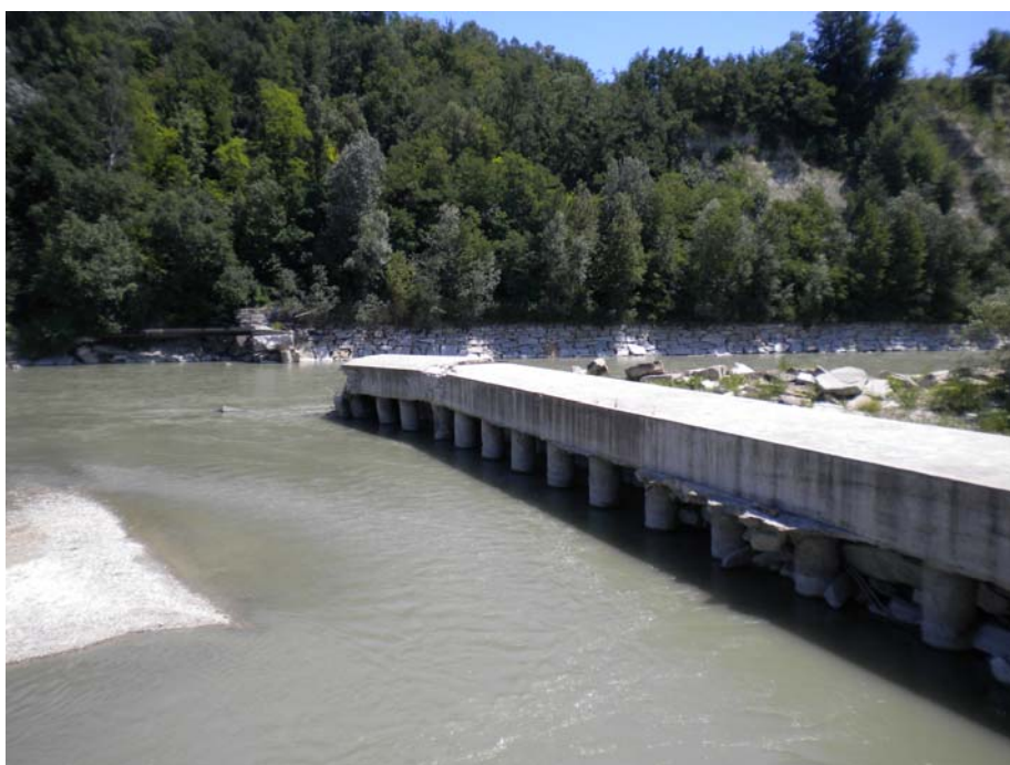
Fig. 2.2 Traversa esistente dopo il crollo del novembre 2010.
