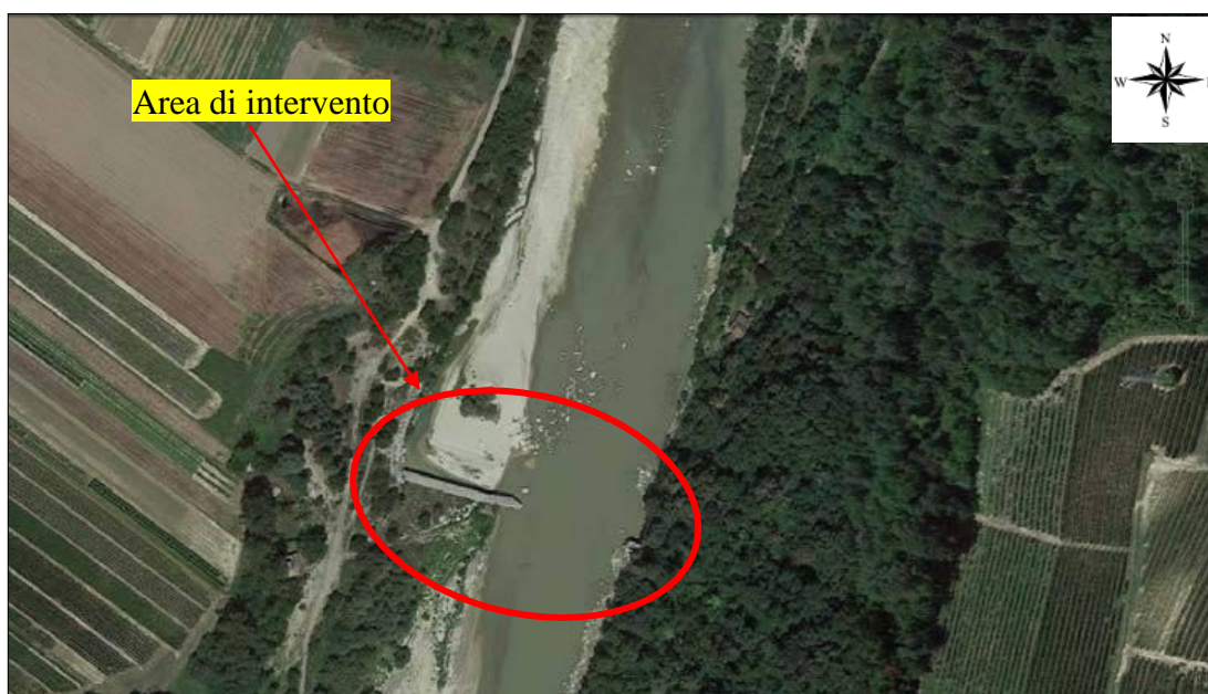
Figura 3-2 – Dettaglio della traversa esistente in evidente stato di dissesto a causa del crollo del novembre 2010 (Google Earth)
