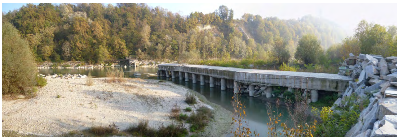
Figura 1. I resti della traversa crollata nel novembre del 2010
