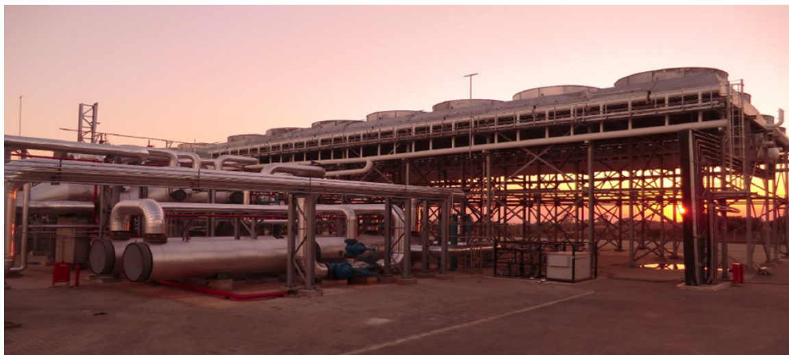
Figura 3-8 Centrale geotermoelettrica ORC in esercizio (Fonte:Exergy)
