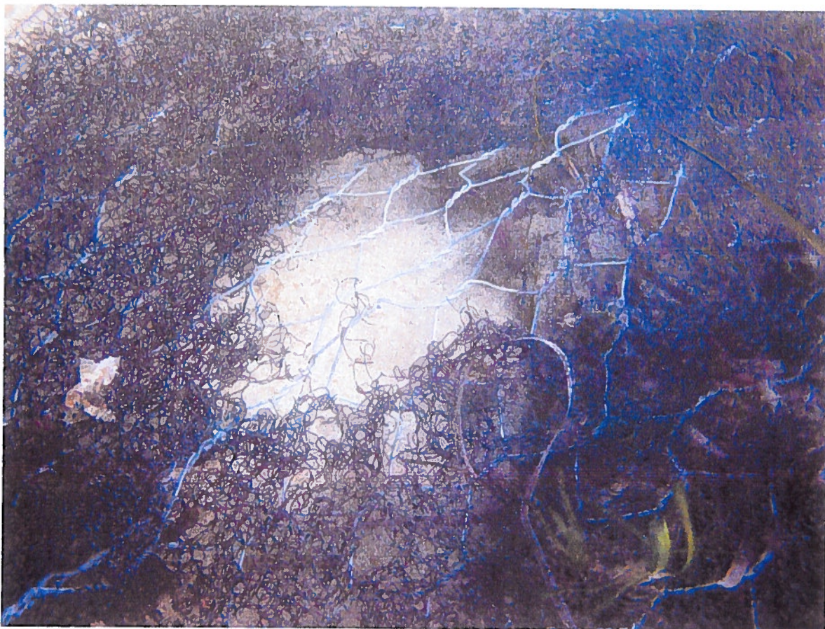
Fig. 6 – Evidenti segni di ancoraggio con asportazione di porzione di supporto plastico e sollevamento delle rete metallica.
