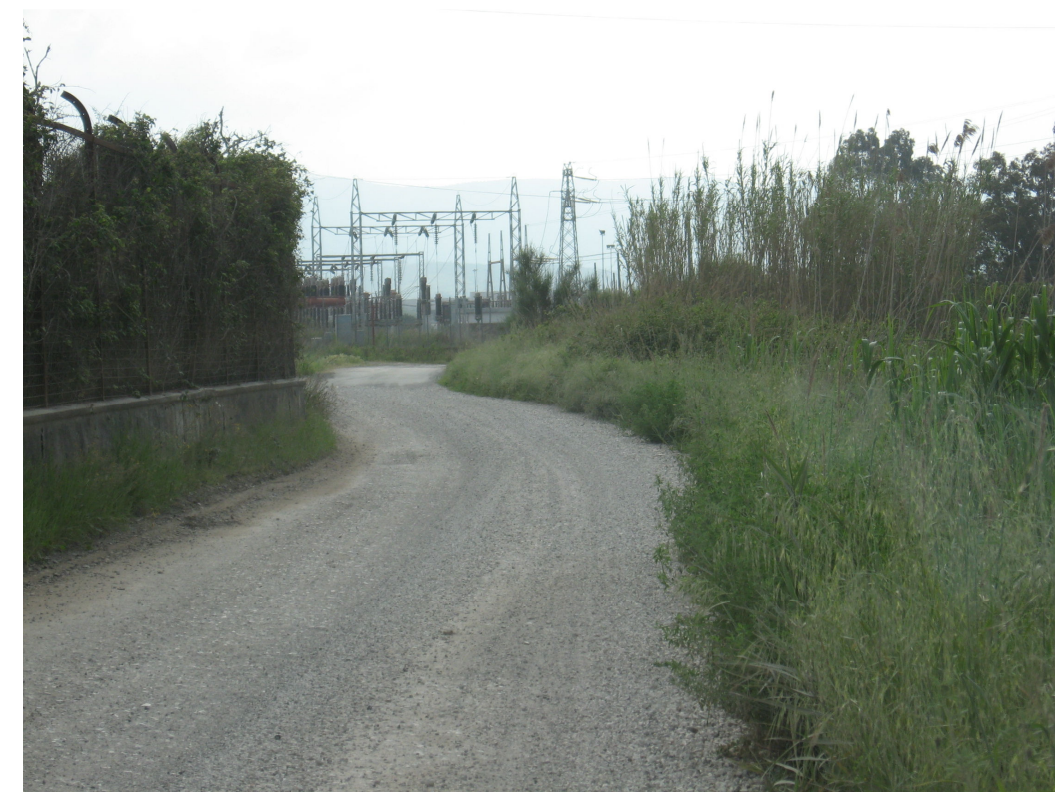
Foto 14: La Stazione Elettrica di Colmata.
