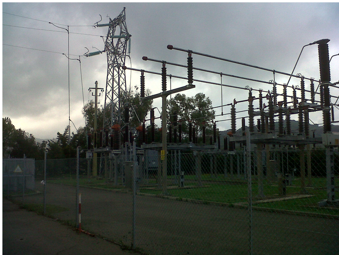
Foto 1: CP Portoferraio, vista dell'area ove sorgono le installazioni elettriche esistenti.
