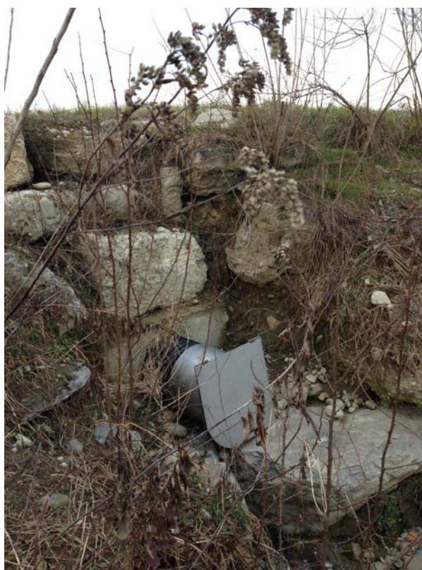
foto 3: particolare dello sfioratore del SISI dotato di valvola antiriflusso.
