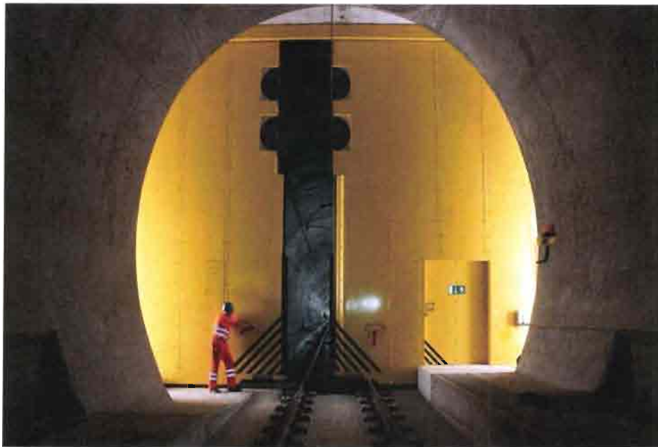
Figura 11.25 - Porte scorrevoli disconnessione fumi (Galleria Lötschberg)
